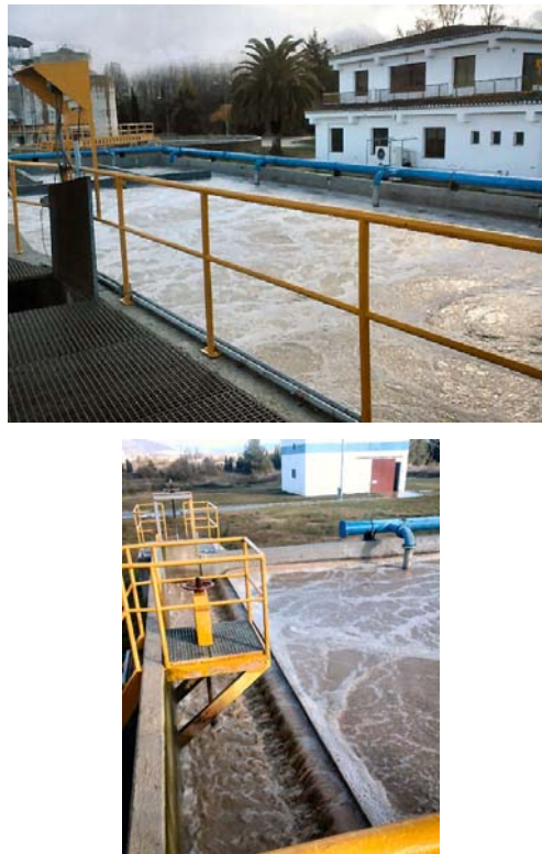
Figura 2.4. Tratamiento secundario convencional con fangos activados: reactores biológicos.
