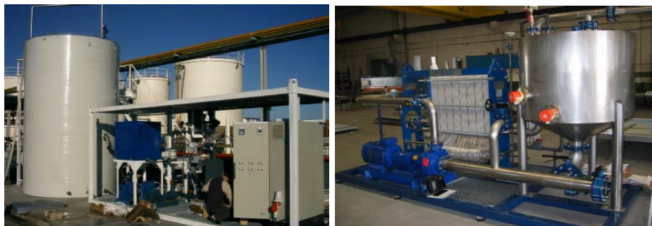
Figura 3.1. Biorreactores de Membrana, instalados por ATM (Asistencia Tecnológica Medioambiental, España). Izquierda: Vista MBR, sector químico; Derecha: Detalle del módulo UF, sector agroalimentario.
