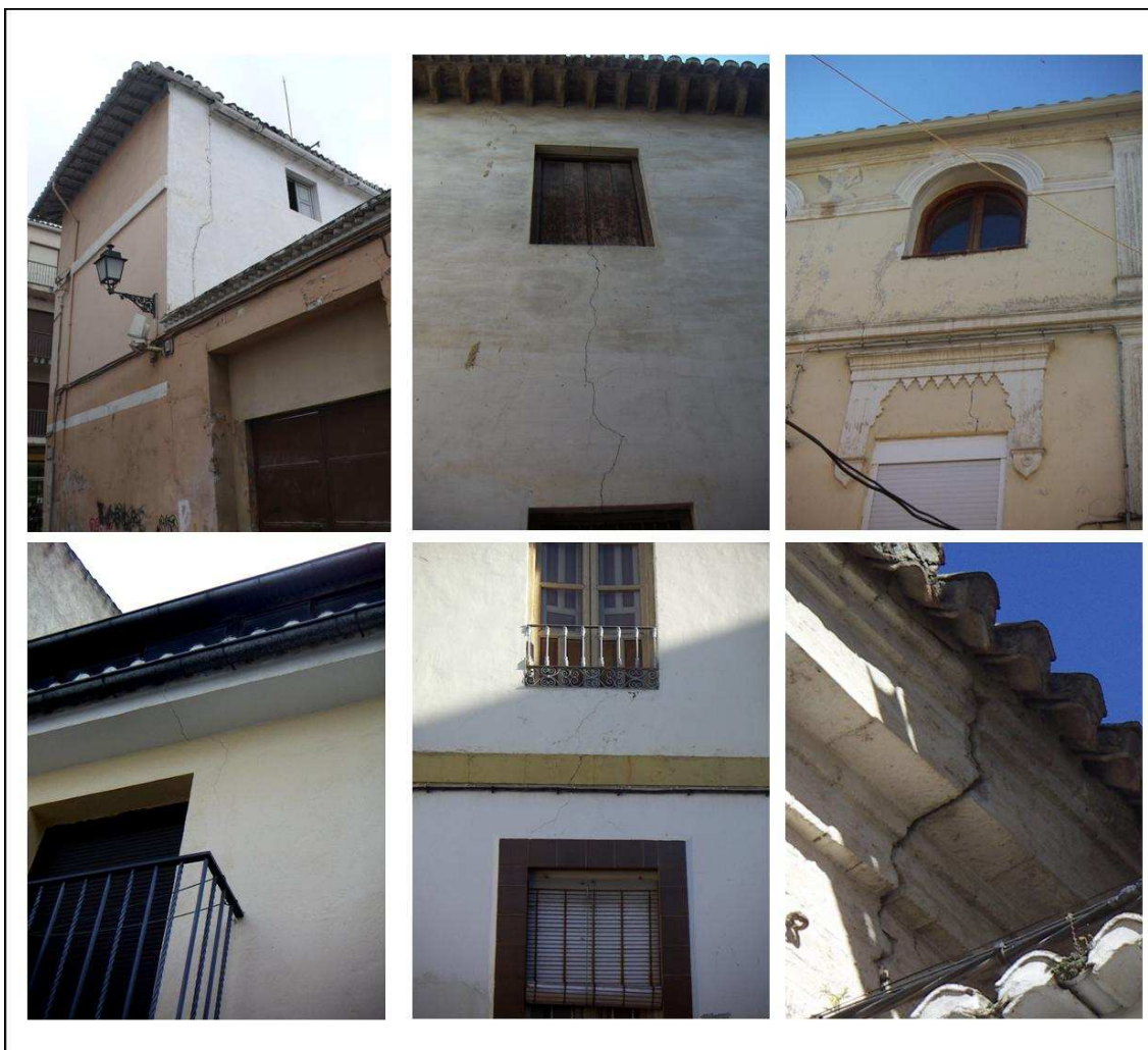
Figura 6.18: Daños en viviendas del centro del casco urbano de Santa Fe.
