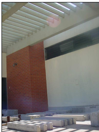
Figura 4.20. Vigas expuestas al exterior del laboratorio
