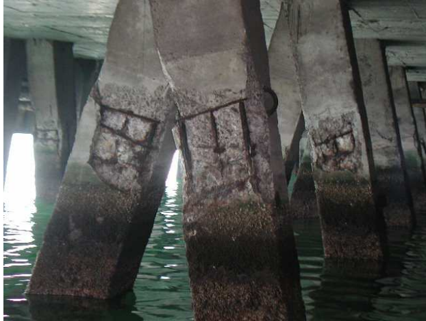
Figura 3.12. Muelle expuesto a un ambiente marino, en su etapa de vida remanente
