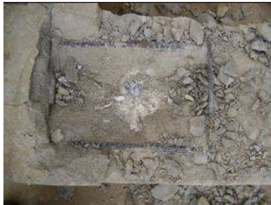
Figura 5.134. Zona de hormigón donde se encontraba embebido el ánodo
