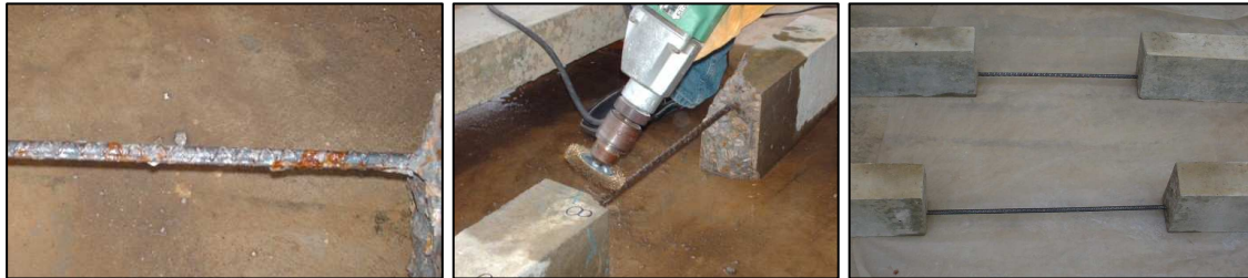
Figura 4.15. Barra con productos de corrosión, limpieza y barra limpia, para proceder a realizar la reparación con el mortero
