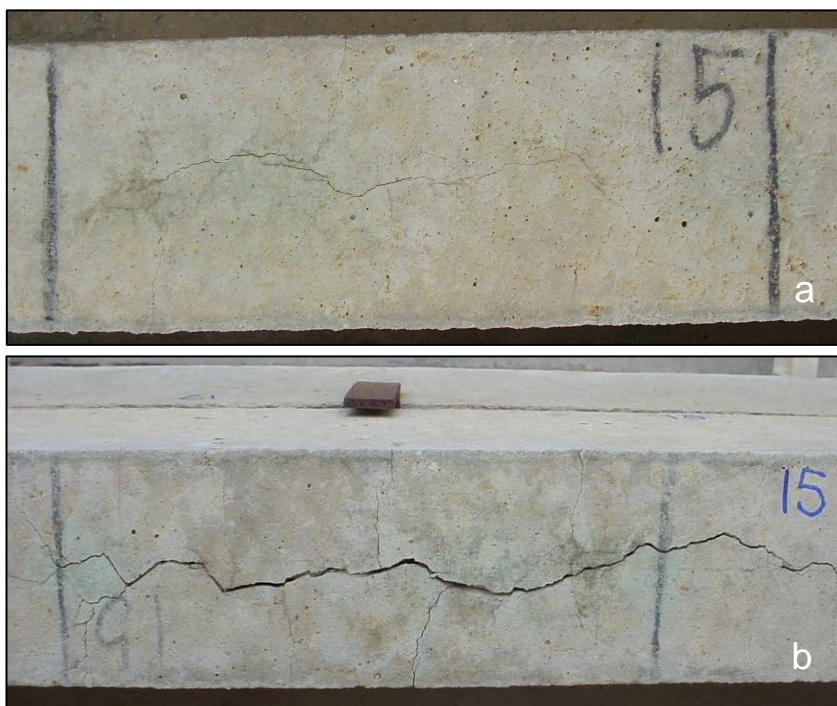
Figura 5.58. Fisuras observadas en la Viga 12.
