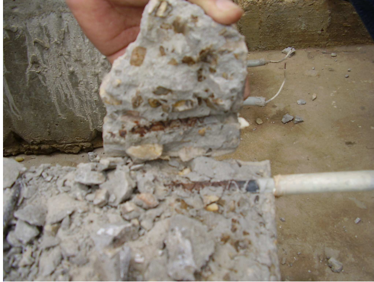
Figura 5.136. Barra de acero con daños por corrosión de la armadura
