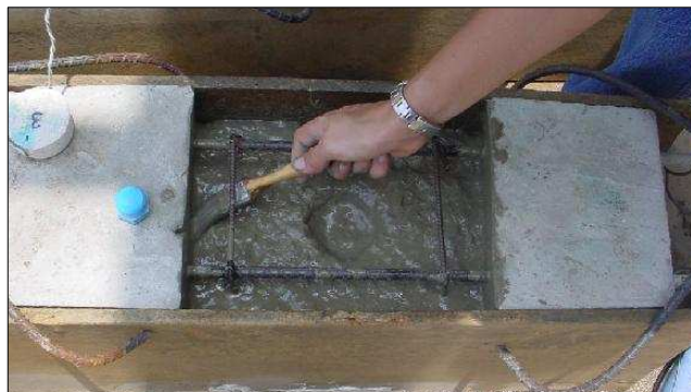
Figura 4.24. Aplicación de pasta de cemento para mejorar la adherencia hormigón contaminado/mortero nuevo
