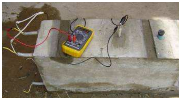
Figura 4.31. Medición de potencial del ánodo de sacrificio embebido en la viga
