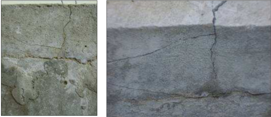
Figura 5.132. Vista lateral de fisuras de las vigas reparadas con ánodos de Al/Zn/In
