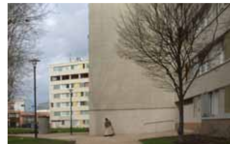
F46_ Bellefontaine, Grand Projet de Ville, resultado rehabilitación fachada grandes bloques Gauguin, Braque. 2.010
