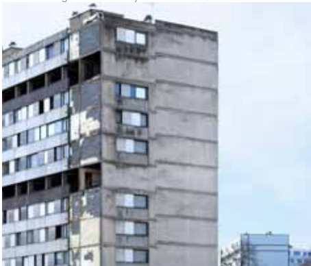
F32_ Bellefontaine, grandes bloques Maurois 2 antes de la demolición según el Grand Projet de Ville . 2.010.
