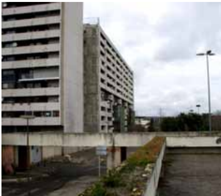
F52_ Reynerie, estado actual dalle conexión jardín de infancia- escuela primaria Daniel Faucher. 2.010.
