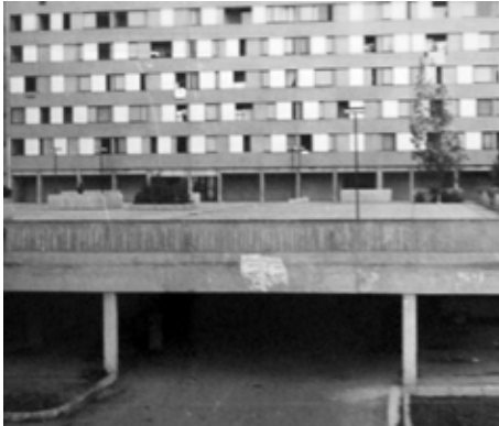
F36 _ Bellefontaine, detalle sección "dalle", aparcamientos- pórticos planta baja grandes bloques, 1.972. CAPA
