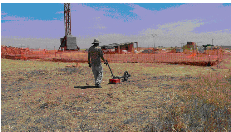
Lám. III.—Adquisición de un perfil georrádar; la antena de 400 MHz se desliza a lo largo de un cordel guía y el odómetro (rueda marcadora) va marcando la distancia horizontal.
