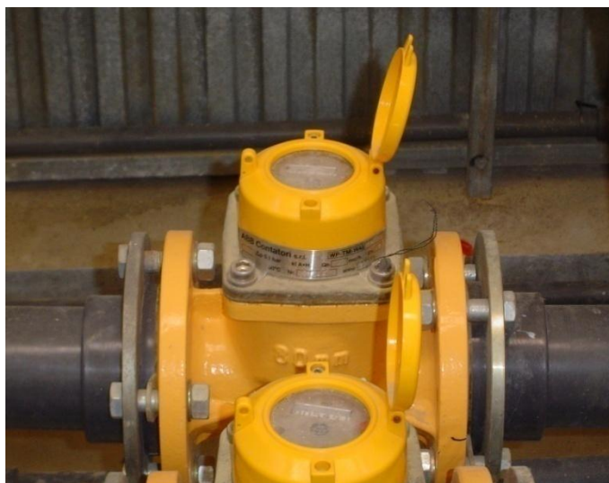
Fotografía n° 29. Detalle de los caudalímetros.
