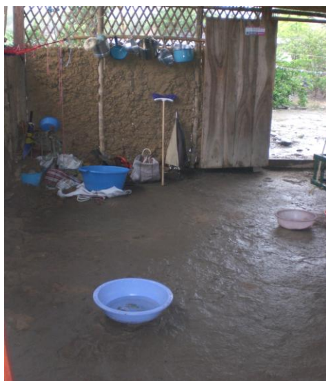
Figura 5.2. Piso de tierra en una vivienda.
