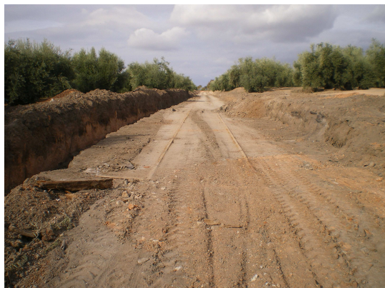
Foto II.2: Vía verde en fase de obras. Vía Verde de la Subbética. Tramo II (Córdoba).
