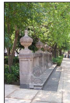
Intervención en el Paseo de la Reforma. En la foto inferior puede apreciarse el deterioro de los bancos de Manuel Tolsá de finales del siglo XVIII.
