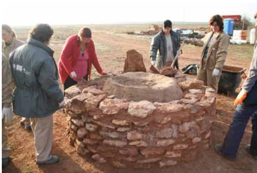
Foto 5.25. Construcción de la bóveda de la estructura relleno el interior con tierra.
