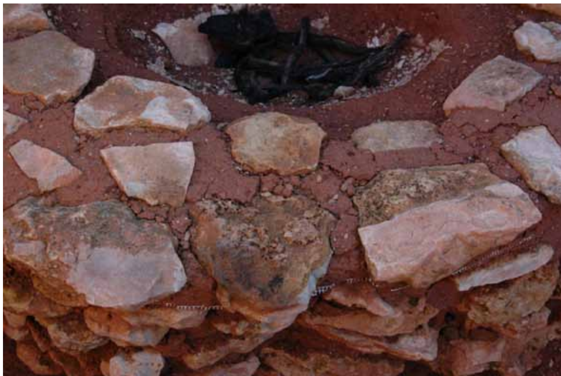
Foto 2.4. Alteraciones producidas por los cambios de temperatura en morteros
