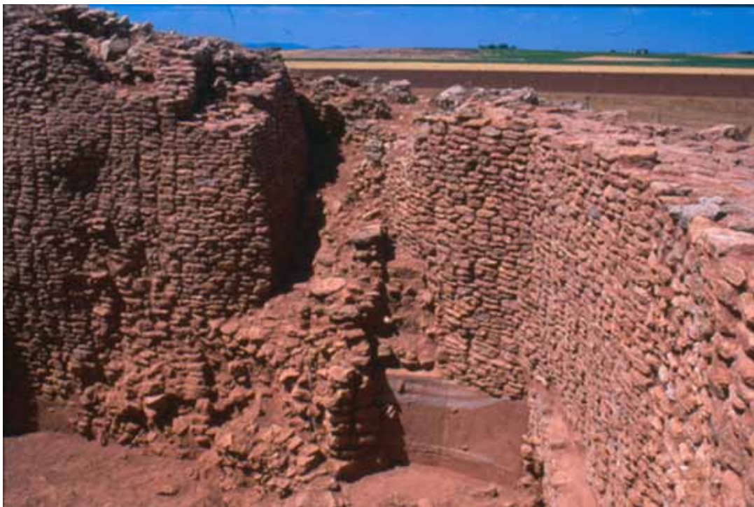
Foto 5.38. Vista del frente Norte y Oriental del Patio tras los trabajos de consolidación.
