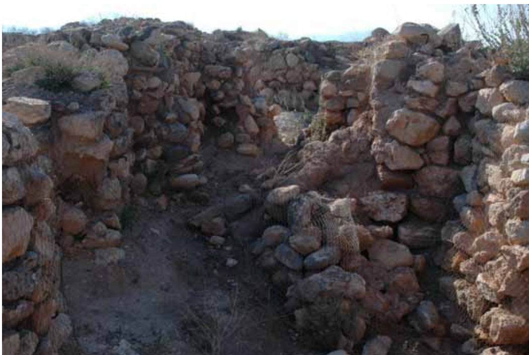
Foto 3.29. Caída de paramentos en el Fortín I, tras las lluvias del 2010.
