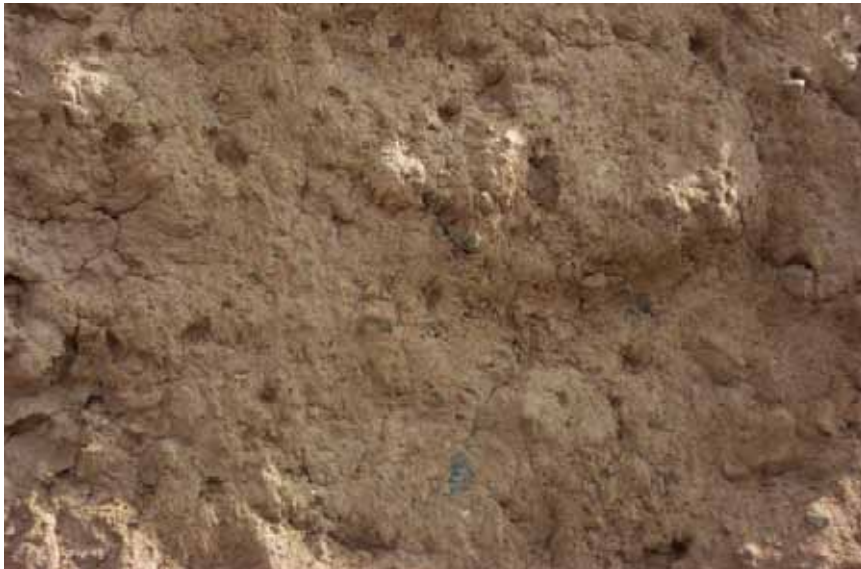
Foto 3.37. Textura del mortero
