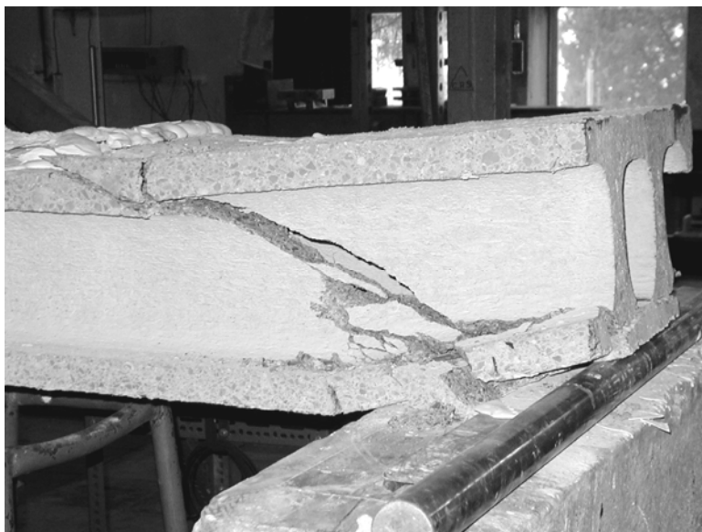
Figura 7.5. Rotura de cortante
