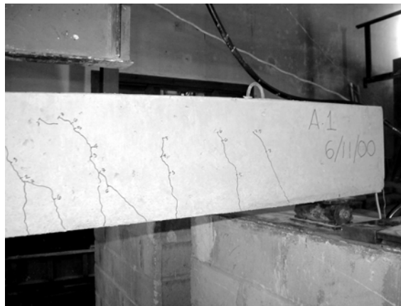
Figura 7.11. Inclinación de fisuras cerca de los apoyos
