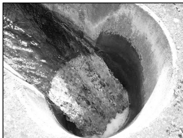
Tubo de rotura de presión actual.
