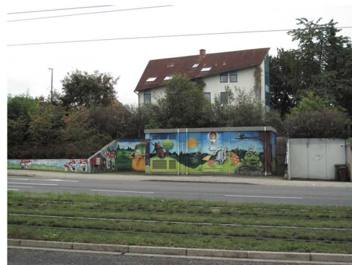
131. Contenedor de limpieza, Kassel
