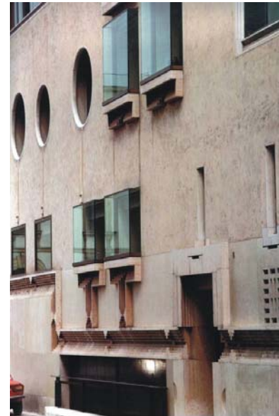
261 Fachada. Escorrentías (f. Antonio Martinelli)
