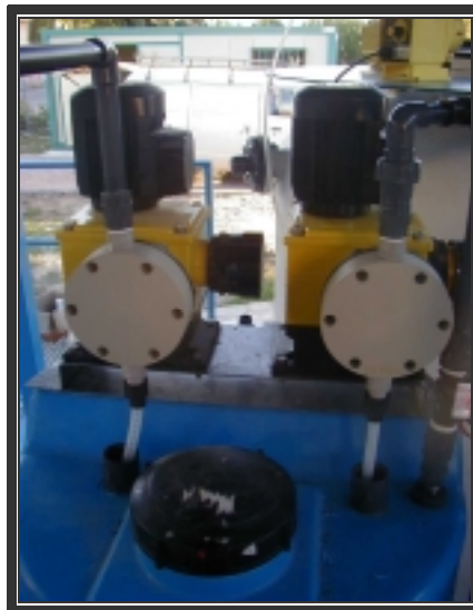
Figura 6.11.- Detalle de bombas dosificadoras de agua al lecho.
