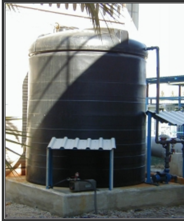
Figura 6.8.- Detalle de depósito de almacenamiento de agua bruta.
