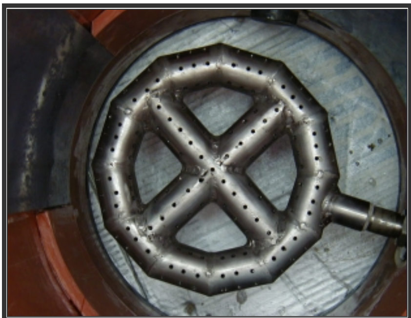
Figura 8.2.- Detalle de sistema de aireación del lavado.
