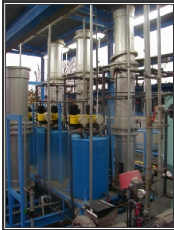
Figura 6.12.- Vista interior planta piloto.
