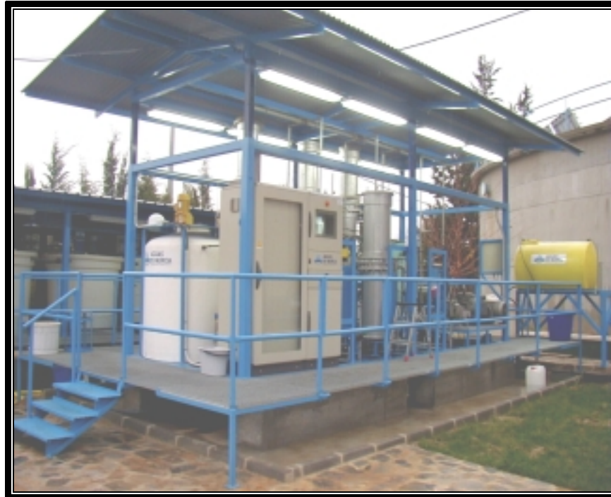
Figura 6.7.- Vista general de la planta piloto.
