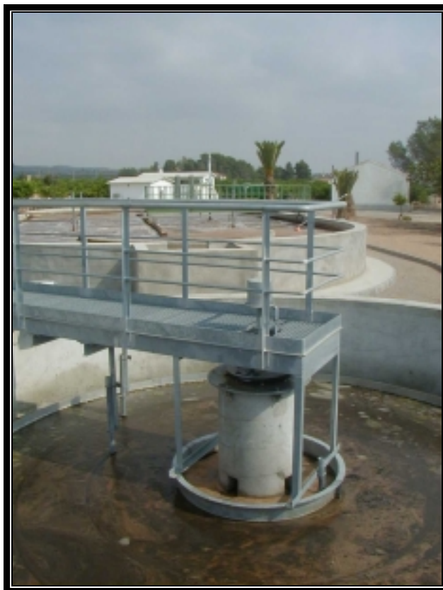
Figura 5.2.- Vista general de planta de fangos activos de la empresa “ARUMEXPORT”.
