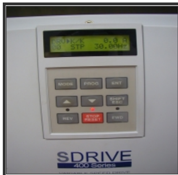
Figura 6.1.- Detalle de variador de frecuencia de la soplante de aire de lavado.
