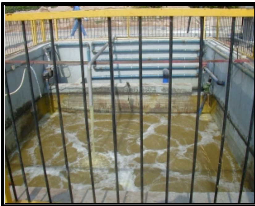
Figura 5.1.- Balsa de Homogeneización de la empresa “Agrumexport”.
