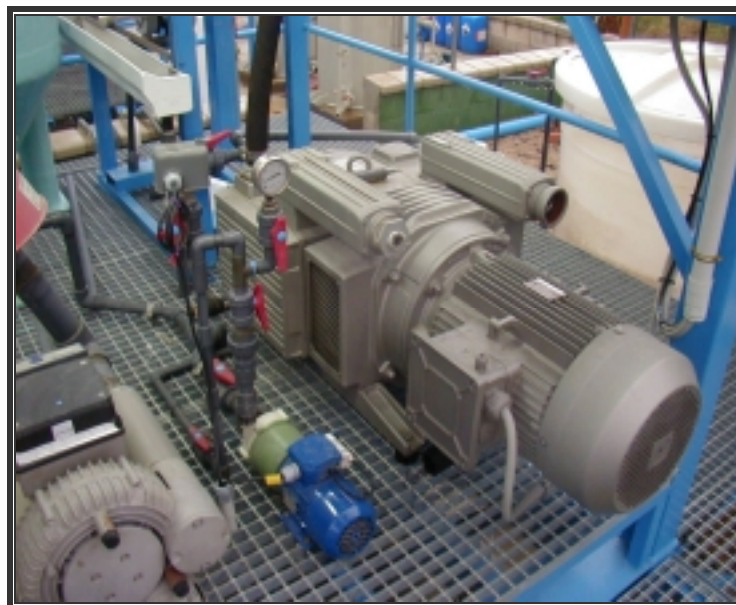
Figura 6.16.- Detalle soplante y bomba de lavado.
