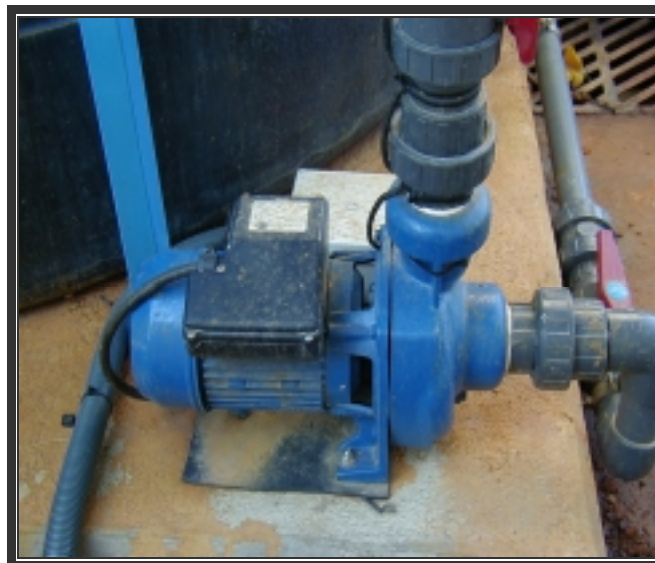
Figura 6.9.- Detalle de bomba de alimentación de agua bruta.
