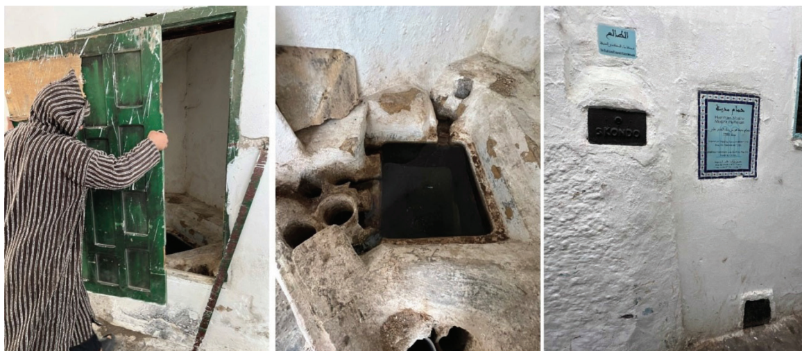
Figura 7. Sistema de reparto de la red Skundo de la medina de Tetuán, estado actual. Izda: apertura, Talaa junto a la mezquita mayor. Centro: control de distribución. Dcha: suministro al hamman
