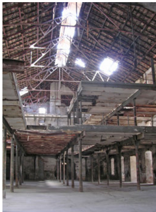
◊ Vista del espacio principal de producción de la Azucarera de San Isidro con la estructura metálica en los forjados tras la reforma de 1920.
