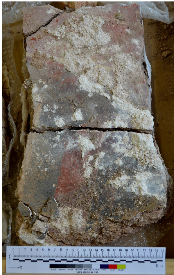
Figura 7: Estado de conservación de los revestimientos murales.
