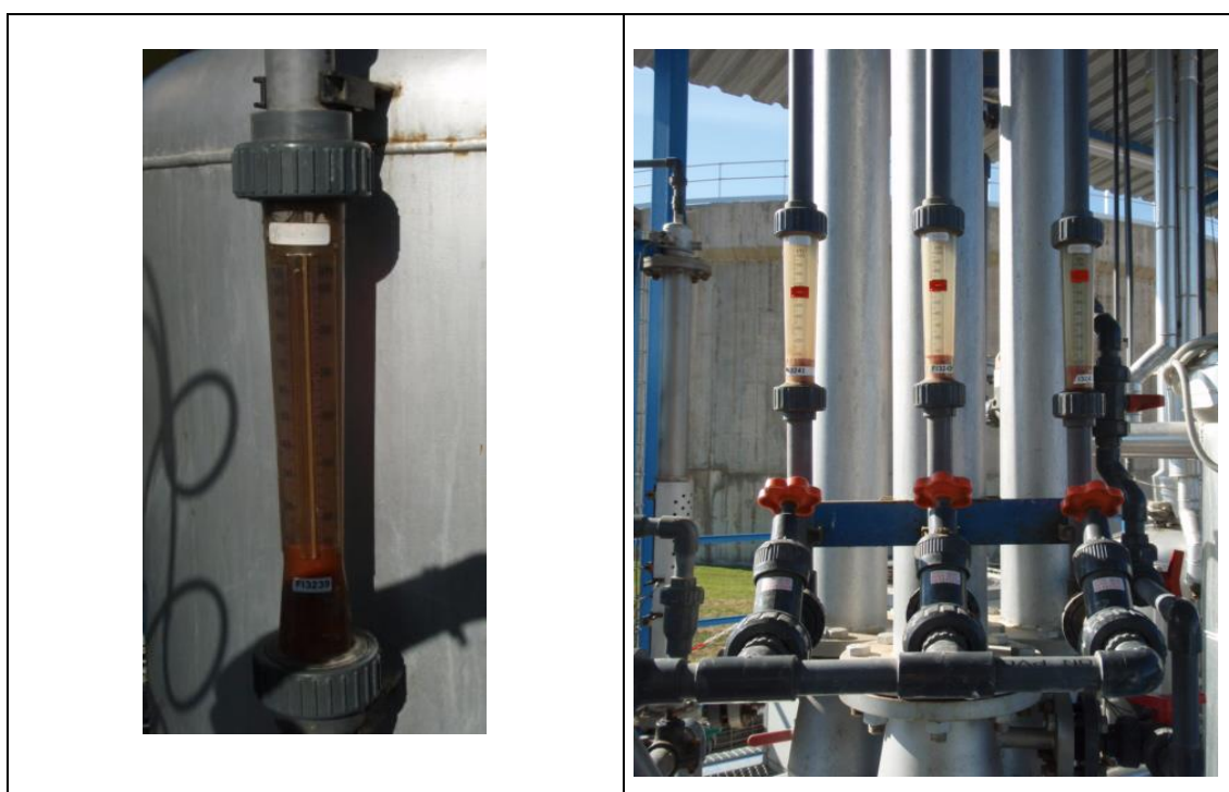
Figura 84: Medición del caudal de amina de entrada al proceso de absorción y la suministrada a cada torre.
