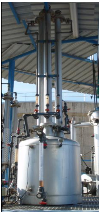
Figura 42: Torre de absorción de CO 2 .
