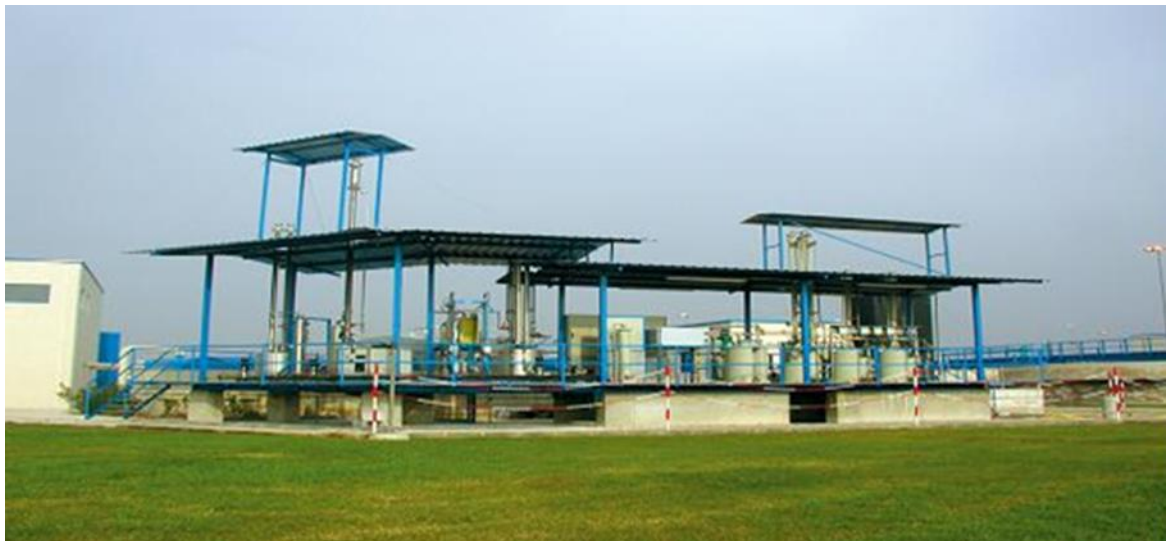
Figura 30: Vista general planta de tratamiento de biogás.
