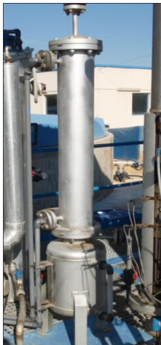
Figura 44: Intercambiador de calor a la salida del biogás.
