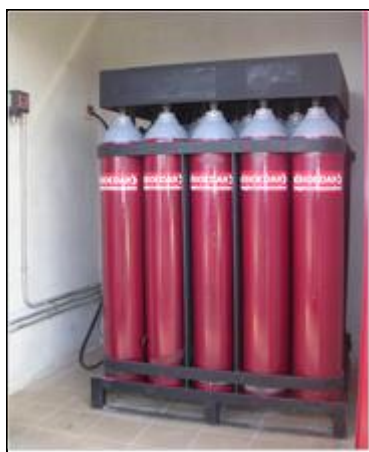
Figura 39: Almacenamiento de BIOEDAR.
