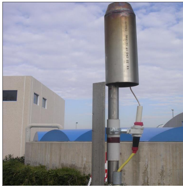
Figura 38: Imagen de la antorcha de la planta piloto de biogás.
