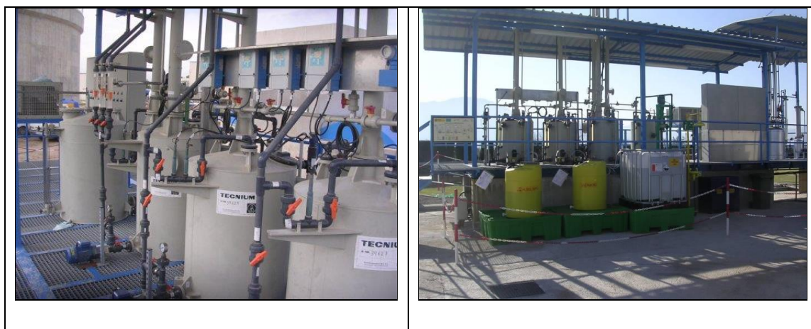
Figura 34: Vista general de las torres de lavado químico ABICEC.
