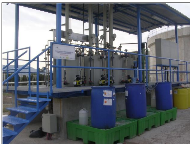
Figura 33: Vista general de la planta de limpieza de biogás.
