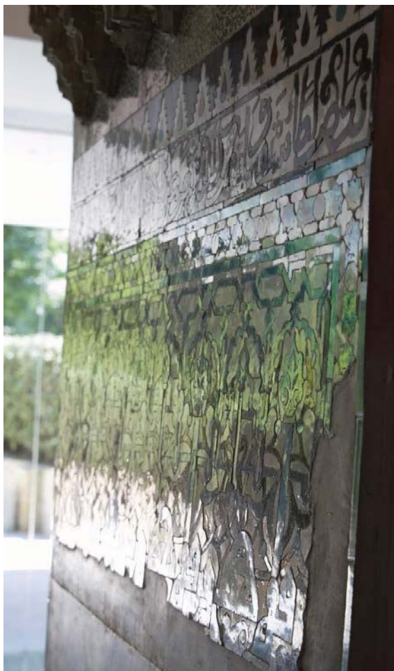
Ilustración 8: Detalle lateral del zócalo de la jamba izquierda del intradós del vano de acceso a la qubba . Fuente: fotografía de autor.
