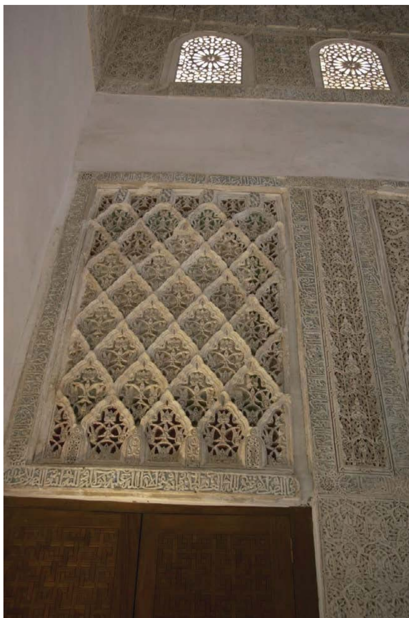
Ilustración 56: Panel de sebka lateral izquierdo del frente este de la qubba . Fuente: fotografía de autor.
