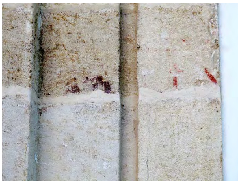
Fot.80 Restos de un rótulo o vítor en la portada
