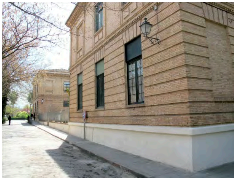
Fots.49-50 Fachadas de los módulos salientes NE y SE donde se ubica la mayor concentración de grafitos.
