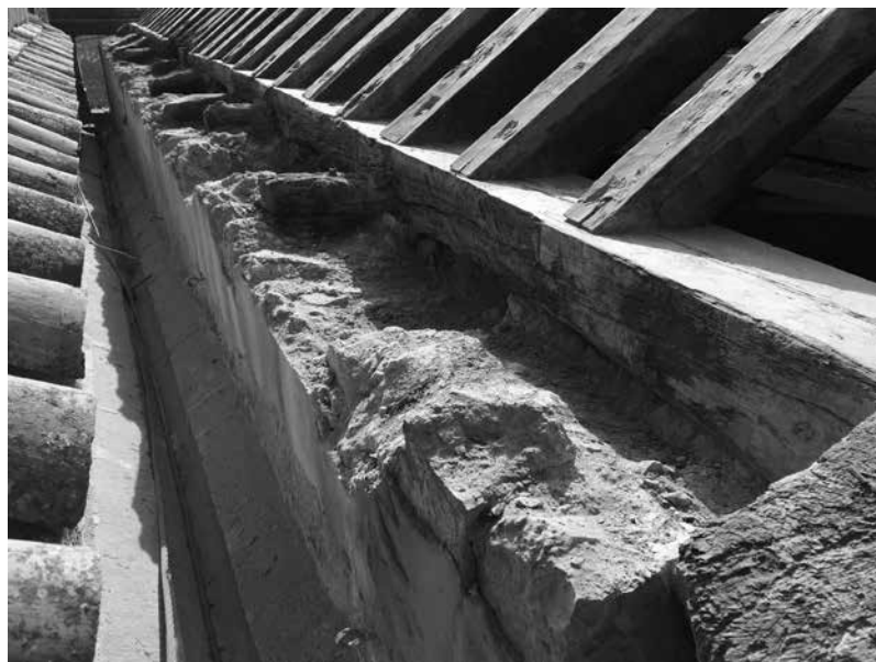
[Fig. 3] Biodeterioro. Pudrición de durmiente y cabezas de tirantes. Catedral de Jaén, 2021.
