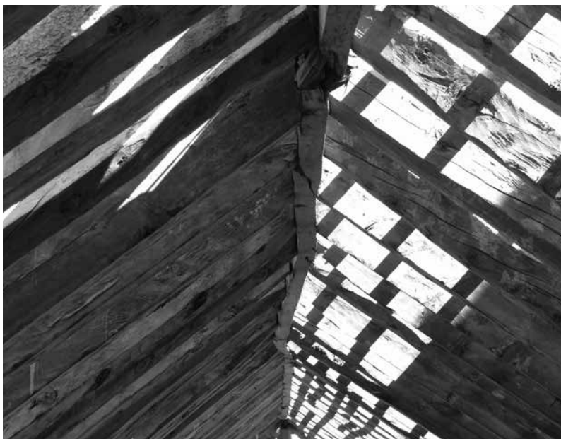
[Fig. 5] Rotura mecánica y pandeo de hilera. Pabellón 11. Catedral de Jaén, 2021.
