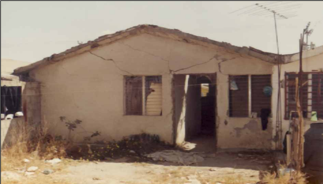
Fotografía N° 3: Agrietamiento generalizado en las viviendas de la Urbanización Don Flore, Venezuela
