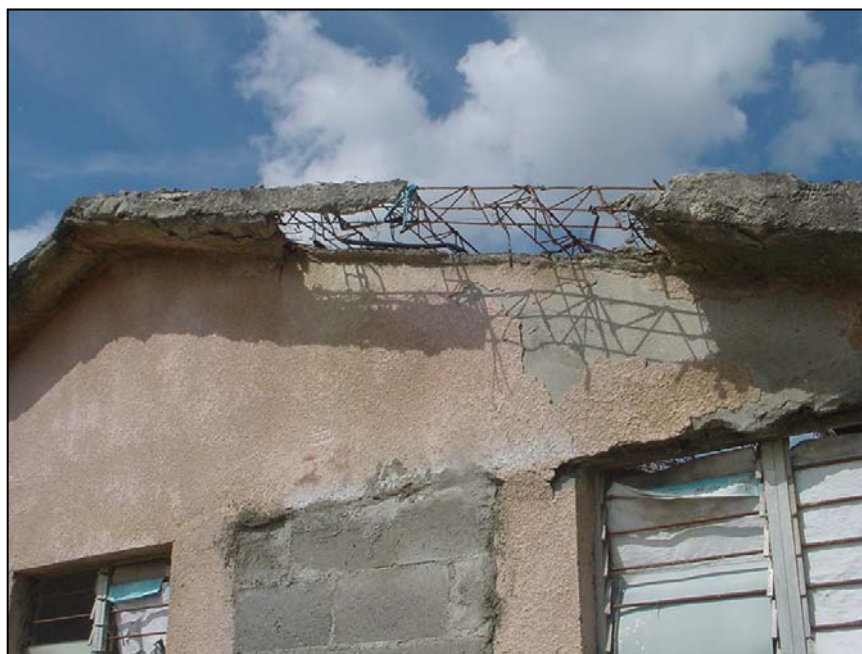
Fotografía N° 23: Véase el desprendimiento de los frisos en techo
