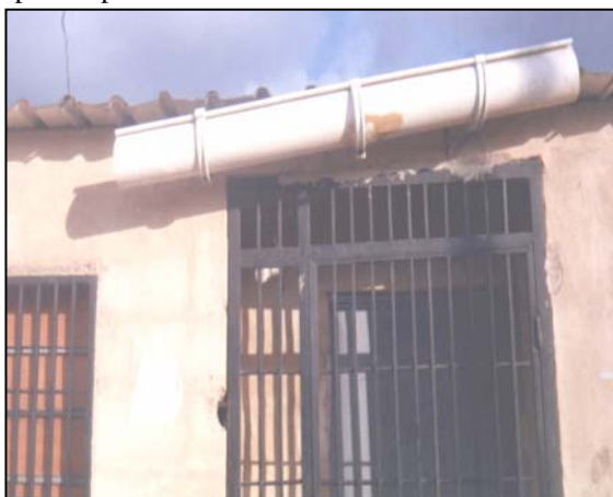
Fotografía N° 27: Canal de Drenaje improvisado, colocado para disminuir entrada de agua de lluvia por las puertas
