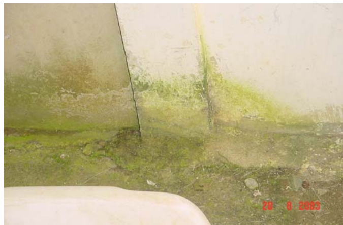
Fotografía N° 17: Se observa la formación de Moho en Paredes.
