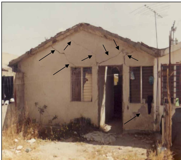
Fotografía N° 22: Viviendas totalmente agrietadas y el metal corroído.
