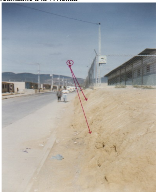
Fotografía N° 25: Véase Socavación del terreno circundante a la vivienda
