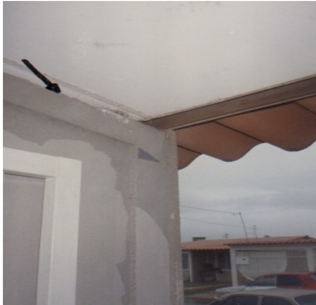
Fotografía N° 20: Véase la humedad en las paredes
