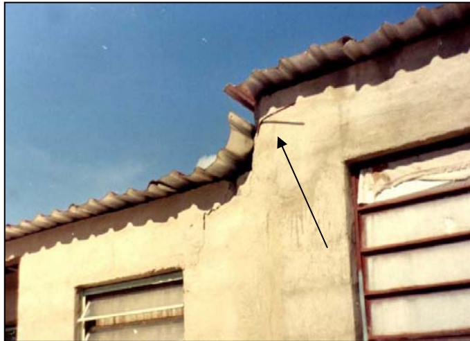
Fotografía N° 16: Los aleros cortos en los techos permiten la entrada de aguas de lluvia por puertas y ventanas, además no existe tratamiento en juntas entre casas que presentan desniveles facilitando las filtraciones
