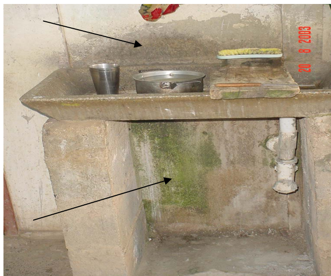
Fotografía N° 21: Pared de servicio con Moho
