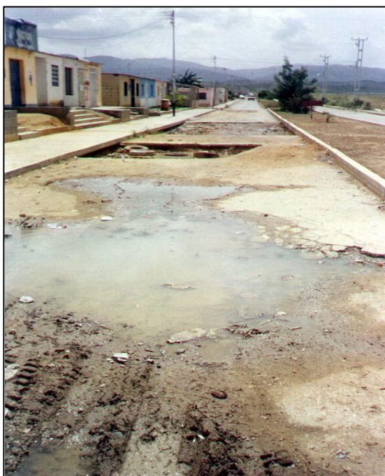
Fotografía N° 29: Condición de la vialidad interna de la Urbanización LS-5.
