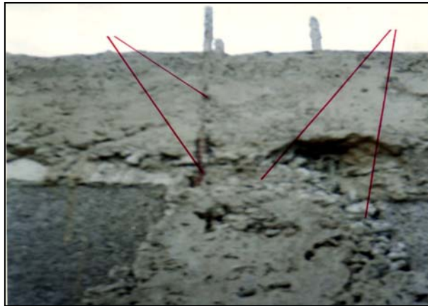
Fotografía N° 15: Obsérvese la coquera (cangrejera) en la junta viga - columna y el acero expuesto.
