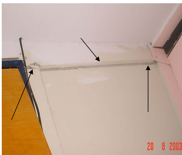
Fotografía N° 19: Nótese la condición de la Junta entre láminas
