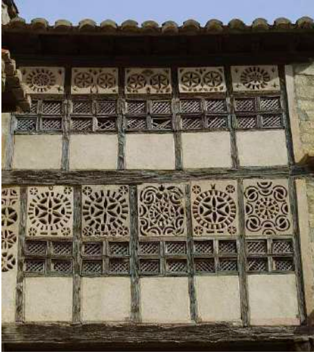
Ilustración 2. Balcones con celosías del convento de monjas agustinas de Teruel. Fotografía de Santiago Cabello. Archivo Periódico Aragón. Prensa Diaria Aragonesa SA.
