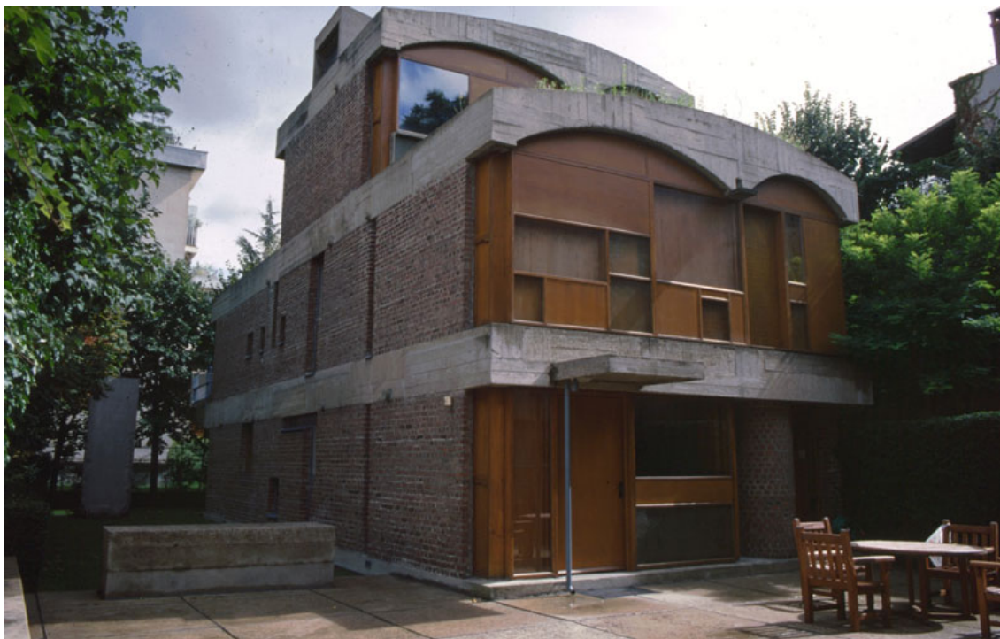
Fig. 8 - La Maison Jaoul 'A' a Neuilly presso Parigi dopo il ripristino delle superfici in cemento faccia-a-vista eseguito alla fine degli anni Ottanta senza alterare la leggibilità delle caratteristiche della tecnica costruttiva originaria e senza cancellare l'assetto storicizzato complessivo dell'opera (foto dell'autore).
