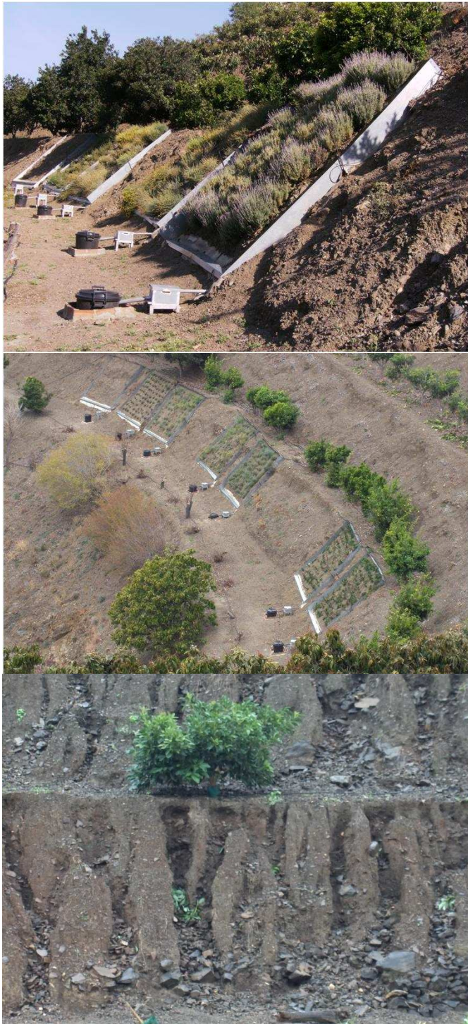
Foto 2. Parcelas de erosión en los taludes de las terrazas con cultivos tropicales y subtropicales. Cárcavas producidas en la terraza tras un evento muy erosivo
