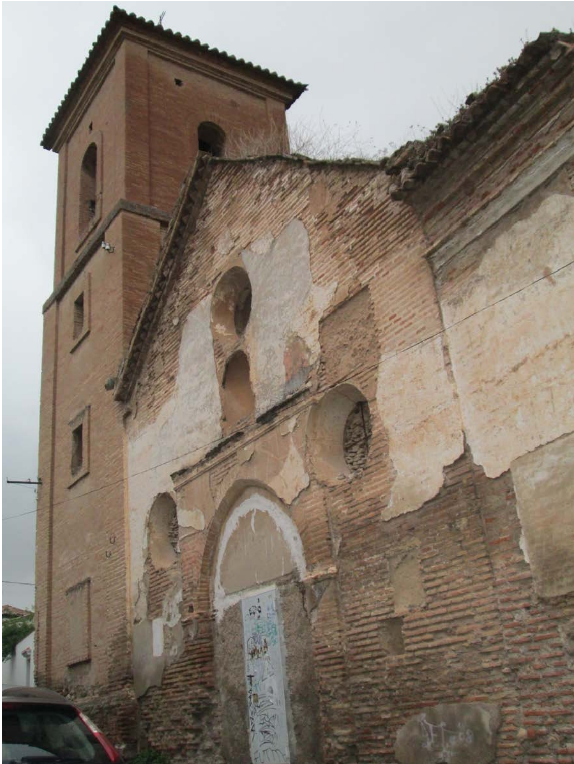
San Luis en su estado actual de abandono.
