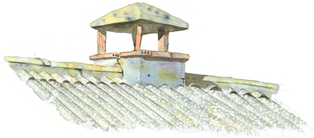
Fig. 46: Chimenea de ventilación sobre cubierta de fibrocemento.
