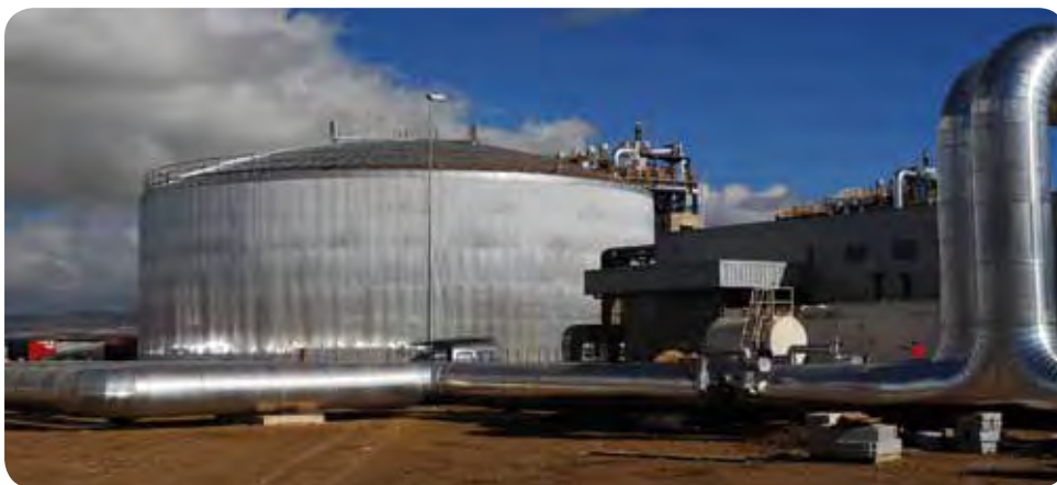
Tanques de almacenamiento térmico con sales fundidas en Andasol I.
