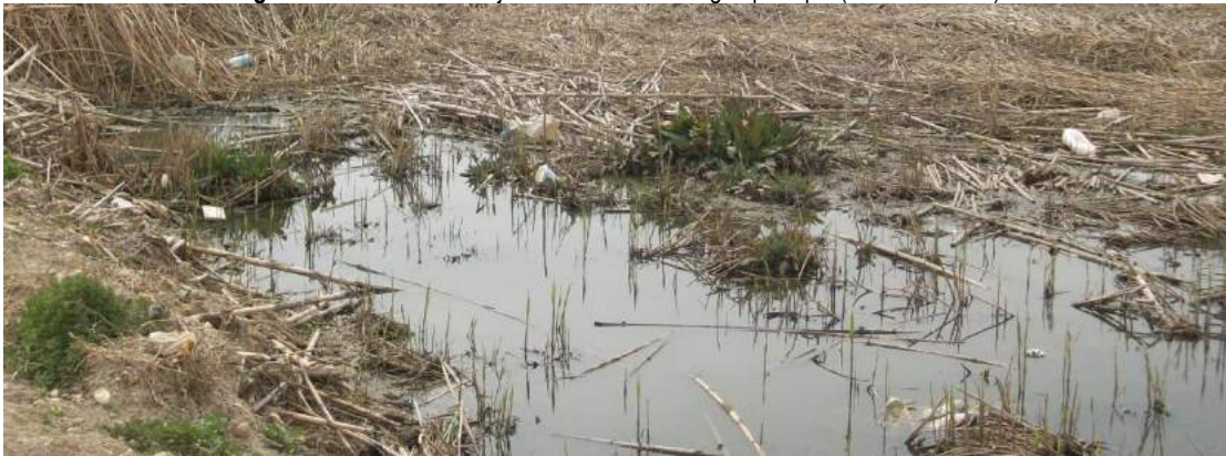
Fig. 169. Residuos sólidos junto al canal de desagüe principal (madre maestra)
