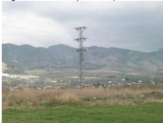
Fig. 164. Tendido eléctrico junto a una superficie de carrizal
