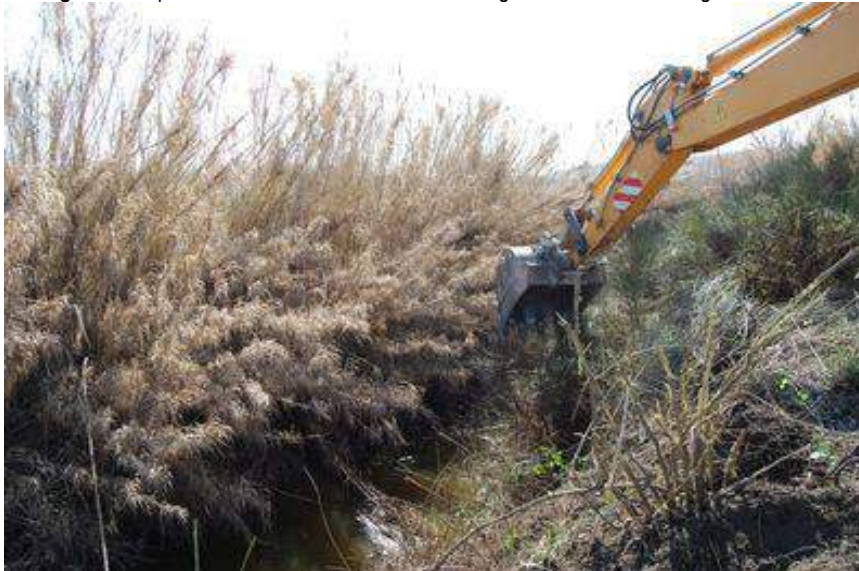
Fig. 130. Limpieza de las madres o canales de desagüe en el año 2011. Laguna de Padul
