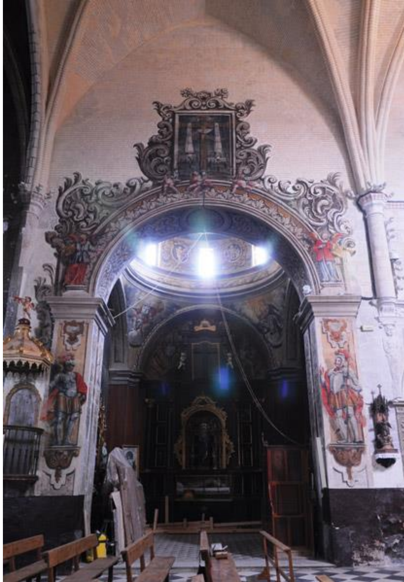
Link 45. Portada restaurada de la capilla de la Soledad. Fuente: Albarium S.L.
