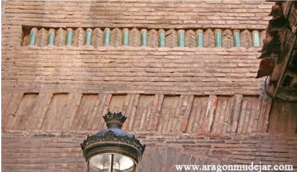
Link 05. Detalle de banda decorativa de ladrillos inclinados en la cara norte de la torre de la catedral de Santa María de Mediavilla, Teruel. [15/12/2014]
