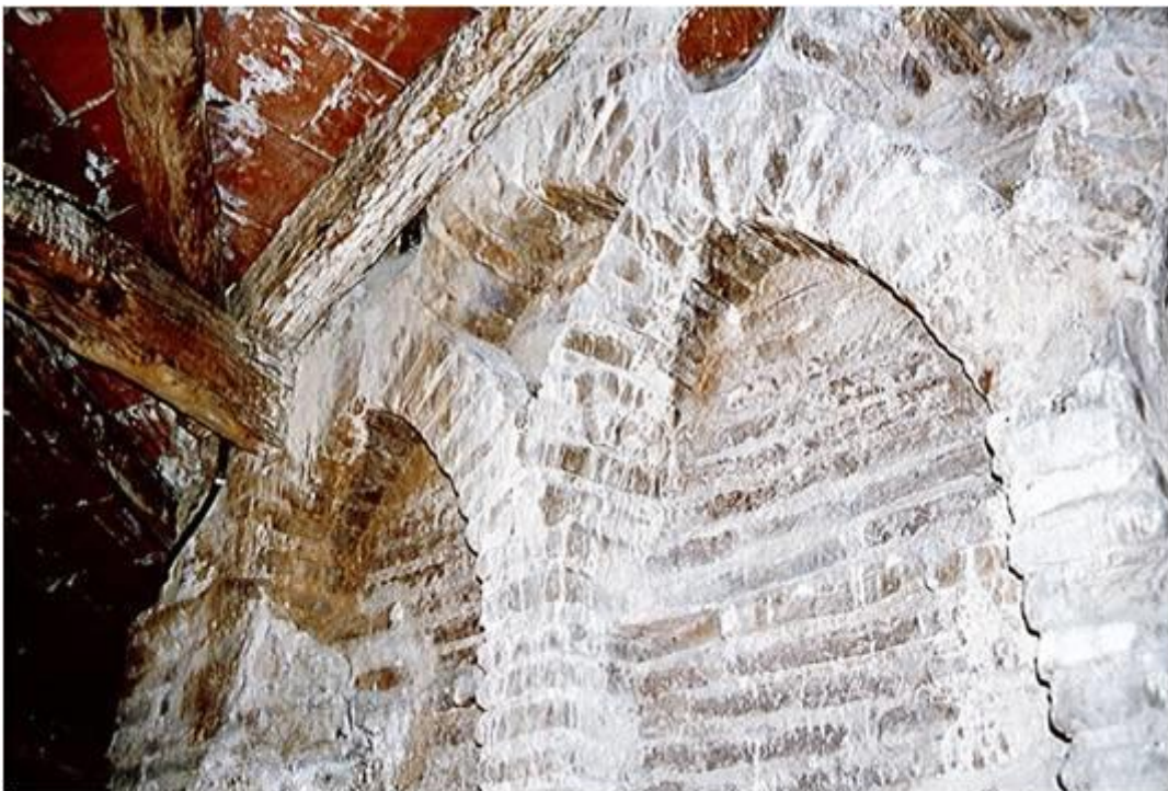
Link 27. Afecciones en el interior. Fuente: Elaboración propia.
