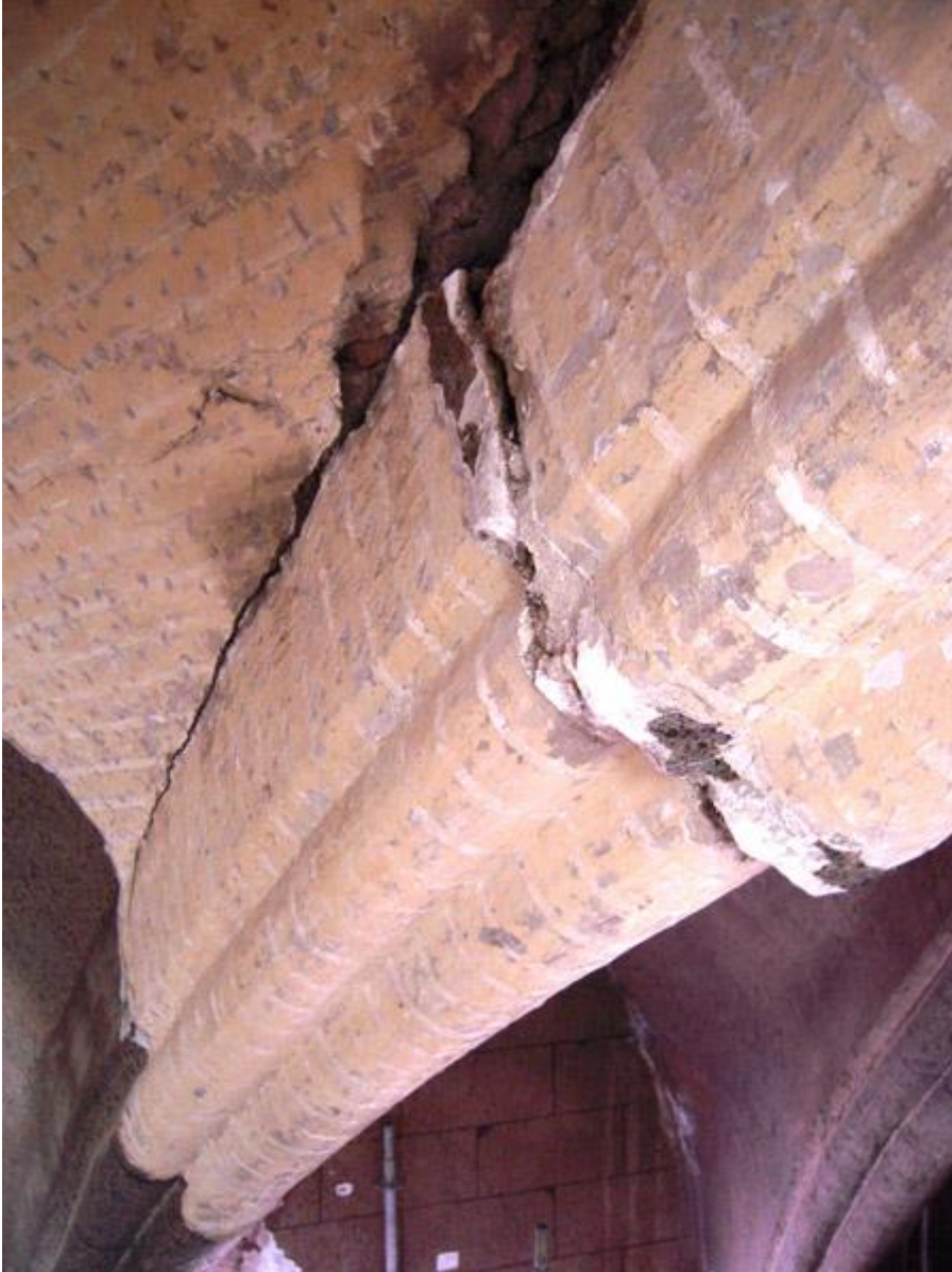
Link 38. Grietas consolidadas y tapadas en el s. XVI, que volvieron a quedar a la vista tras retirar ese revoco. Fuente: Elaboración propia.
