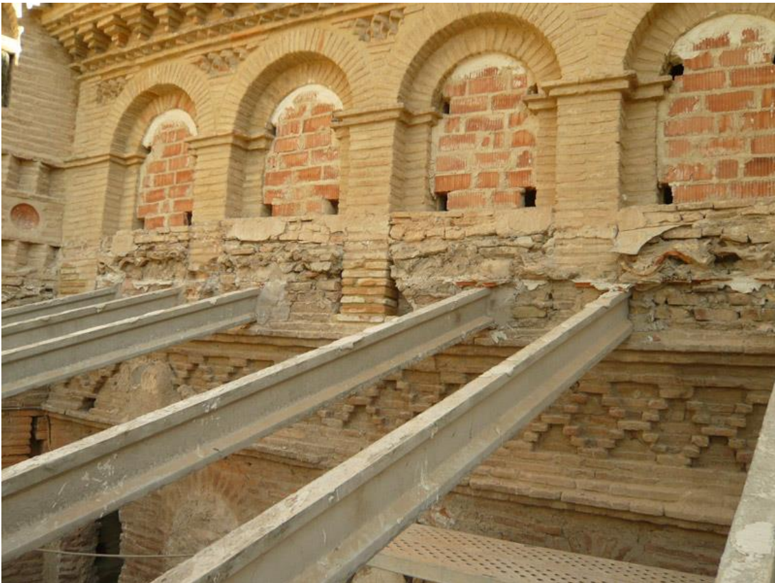
Link 32. Desmontaje de la cubierta sobre la capilla del Niño Jesús. Las viguetas apoyaban sobre el antepecho de la galería. Fuente: Elaboración propia.
