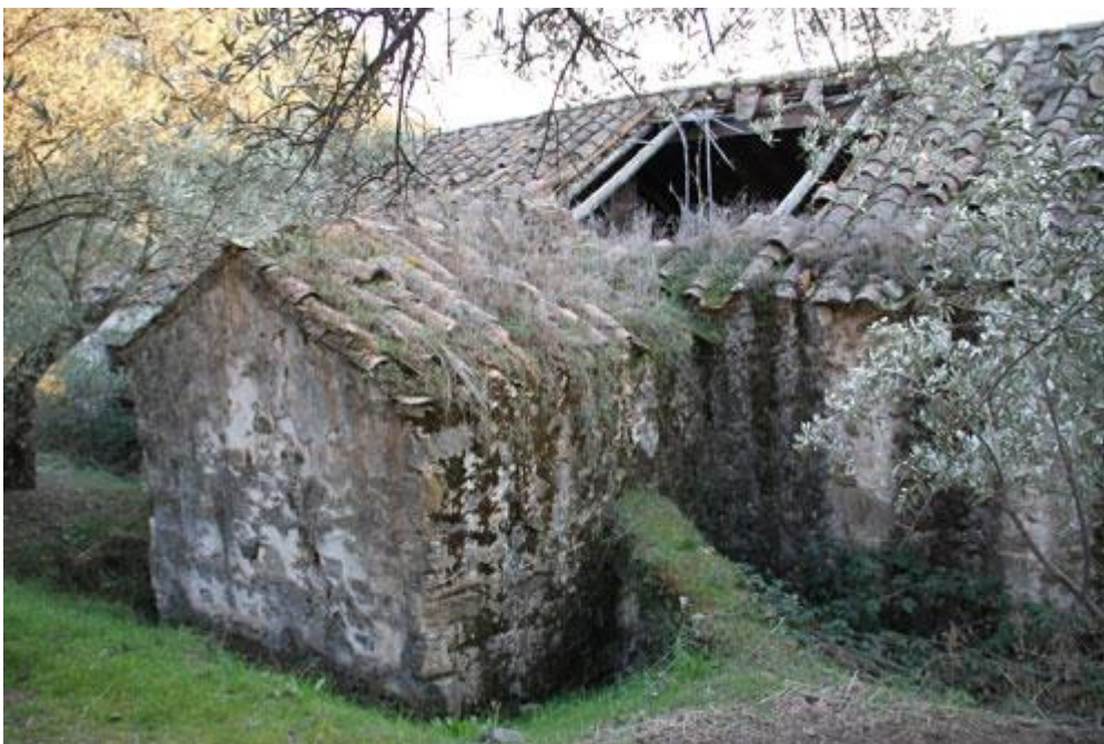
Ilustración 06. Vivienda rural en ruinas. Foto: Ricardo M. Luque.
