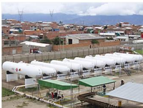
La Planta de Senkata reacondicionó 10 tanques de almacenamiento que permitirán garantizar el abastecimiento de Gas Licuado de Petróleo.
