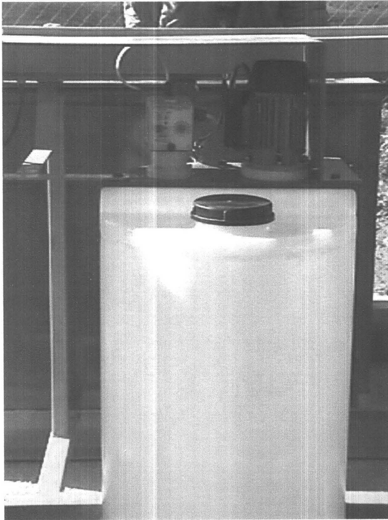
Figura IX.4.- Depósito de etanol y bomba dosificadora.
