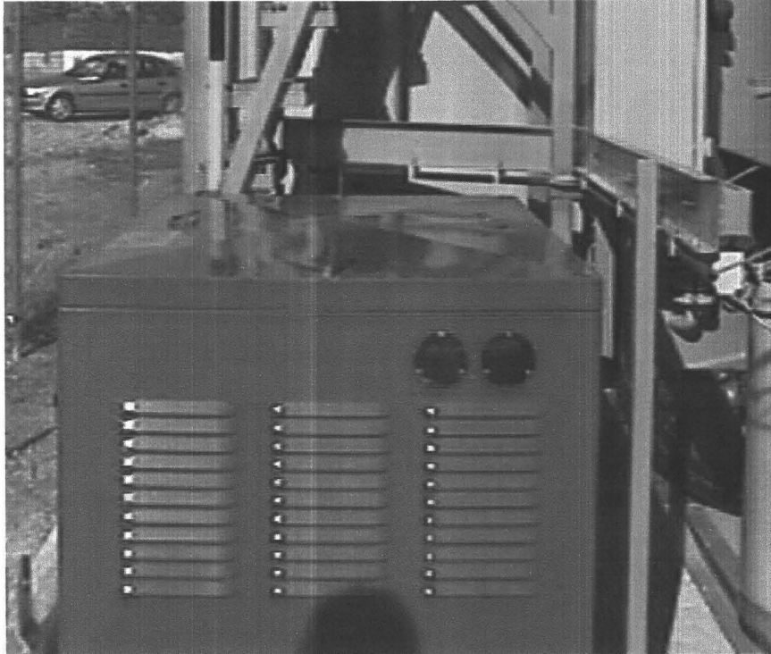
Figura IX.5.- Caja de insonorización donde se encuentra instalado el soplante.
