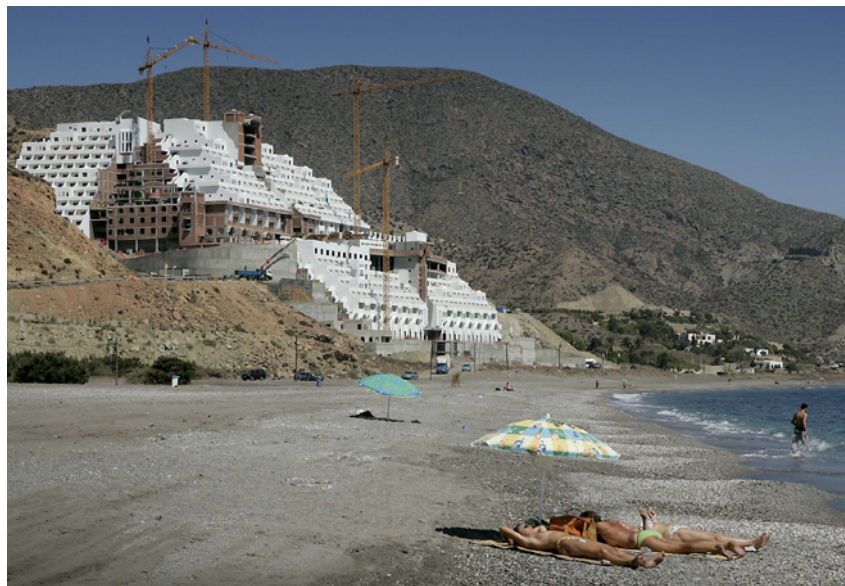
Figura 1.9: Hotel en la playa del Algarrobico en Carboneras (Almería), situado dentro de la zona de servidumbre protegida por la Ley de Costas y cuya construcción se ha paralizado
