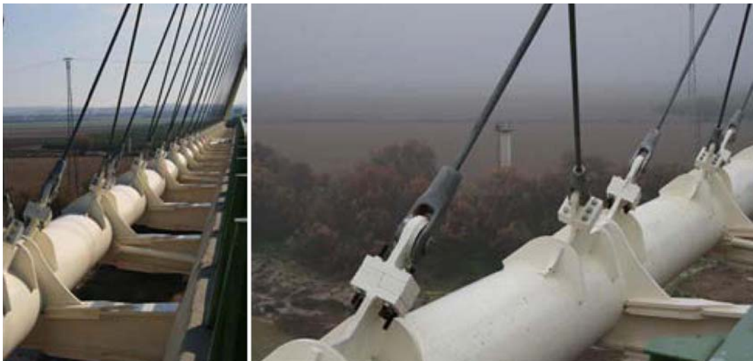
Figs. 5a y 5b: Detalles de anclajes de péndolas inferiores y arranques de vigas transversales dispuestas cada 5 m en el tablero
