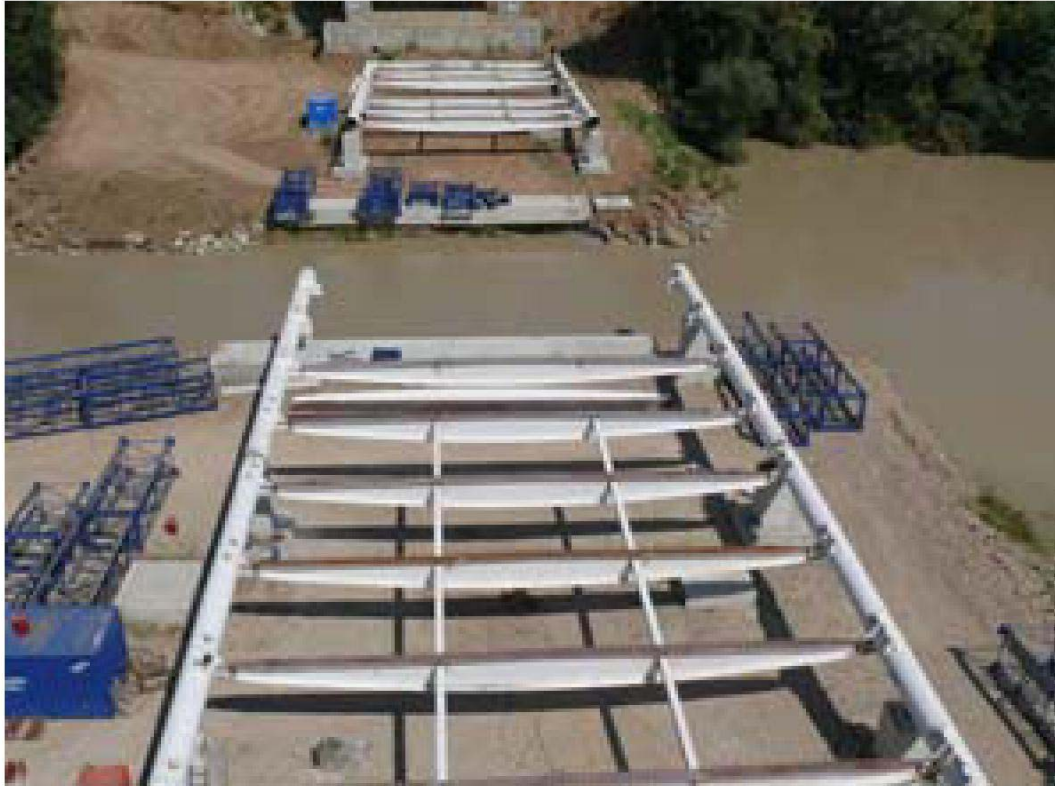
Fig. 7: Vista de las penínsulas artificiales y de las labores de ensamblaje de la estructura metálica del tablero
