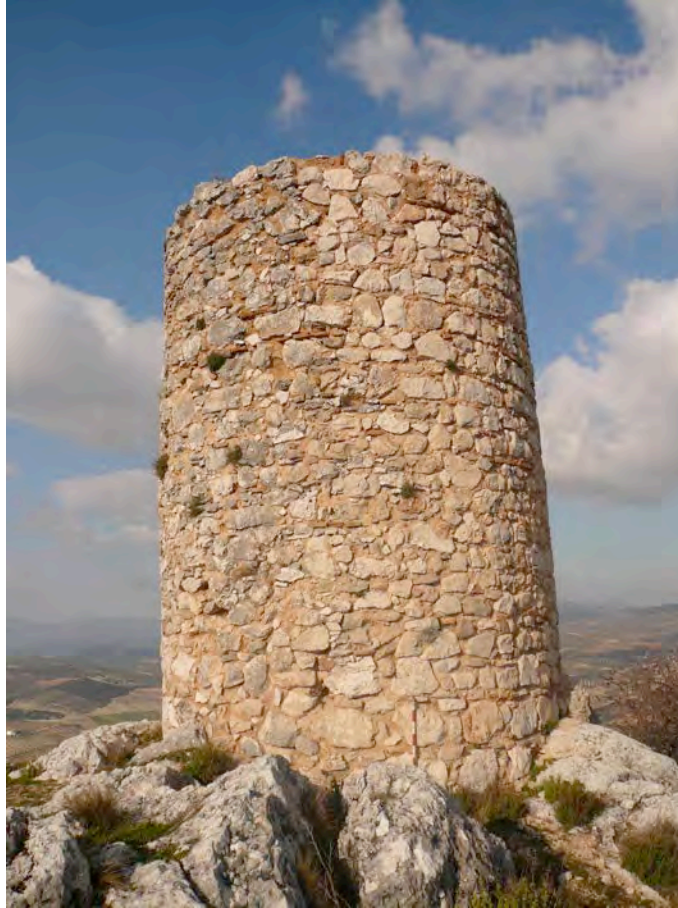
Torre de Mingoandrés restaurada. Se pueden perfectamente distinguir la mampostería originaria (izquierda) de la nueva (derecha)
