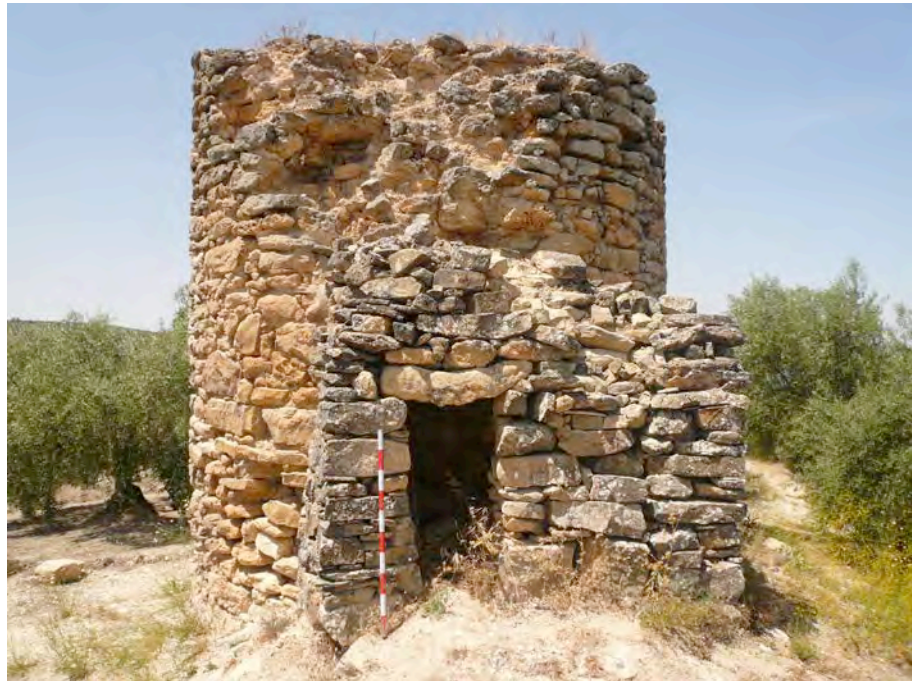
Vista oriental de la torre. Se aprecia la estructura añadida utilizada como refugio rural
