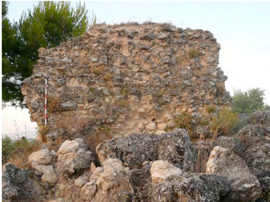
Visión de la torre de la Gallina con los derrumbes de mampostería en su base
