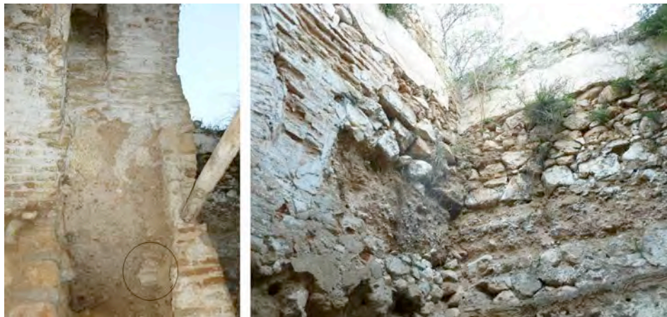
Detalles del tapial perteneciente a la primera fase de la puerta de acceso al castillo
