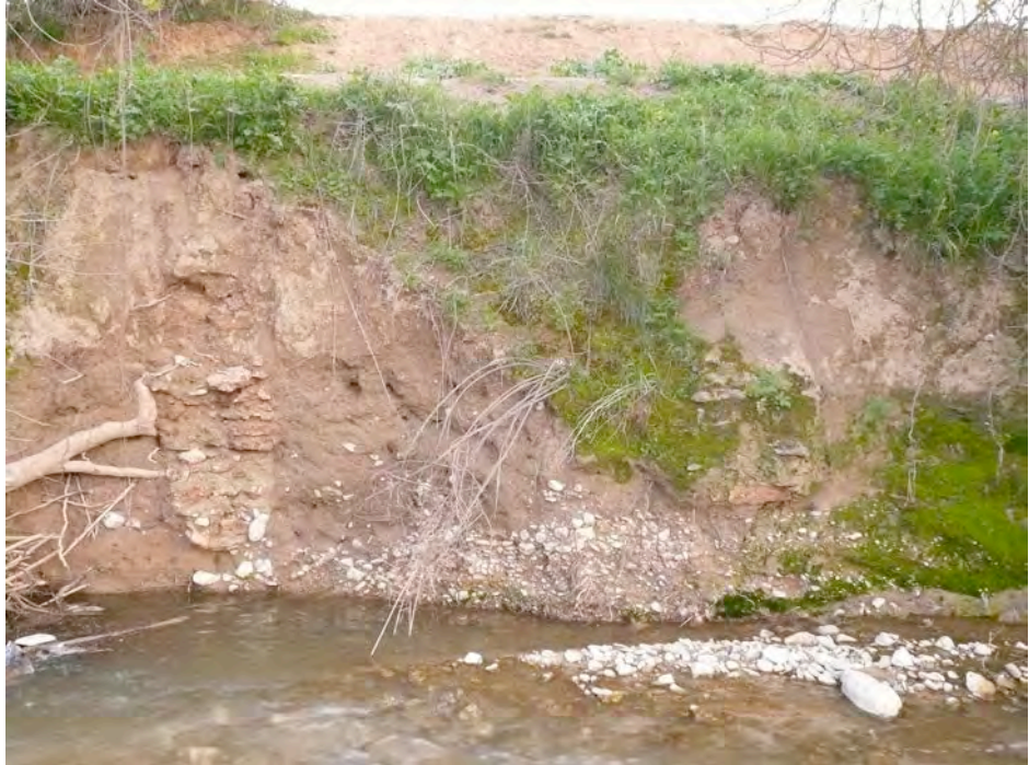
Dos muros de mampostería y ladrillos en el talud formado por el cauce del río
