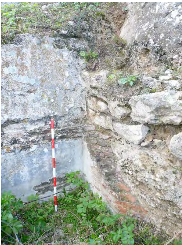
Esquina meridional interior de la aljibe. En el enlucido se e aprecia la curvatura del arranque de la bóveda
