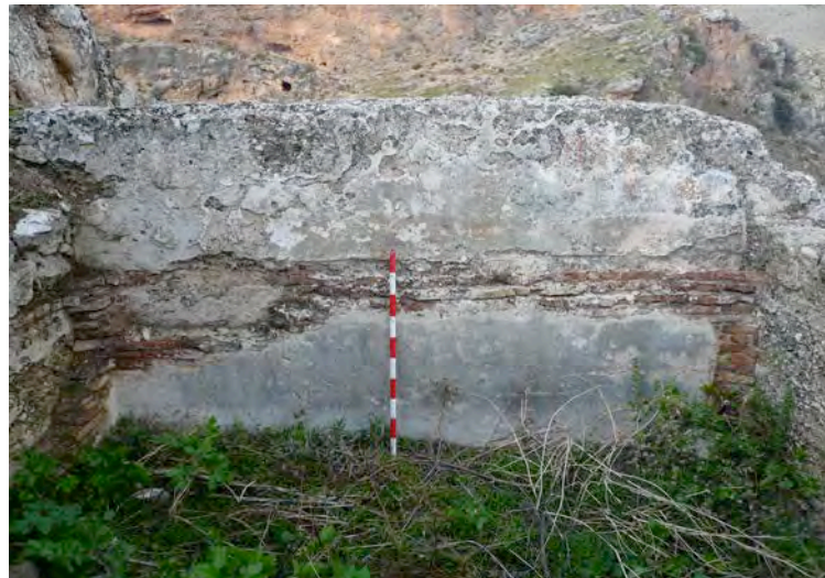
Pared interior oeste del aljibe n.º 1. Se aprecia el revestimiento de ladrillos
