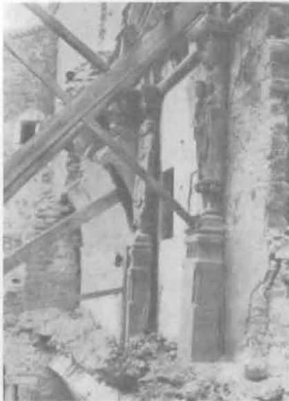
10.1. La Cámara Santa de la catedral de Oviedo, estado tras la voladura de 1934. Foto Alejandro Ferrant. Archivo General de la Administración (AGA). Expedientes de obra.
