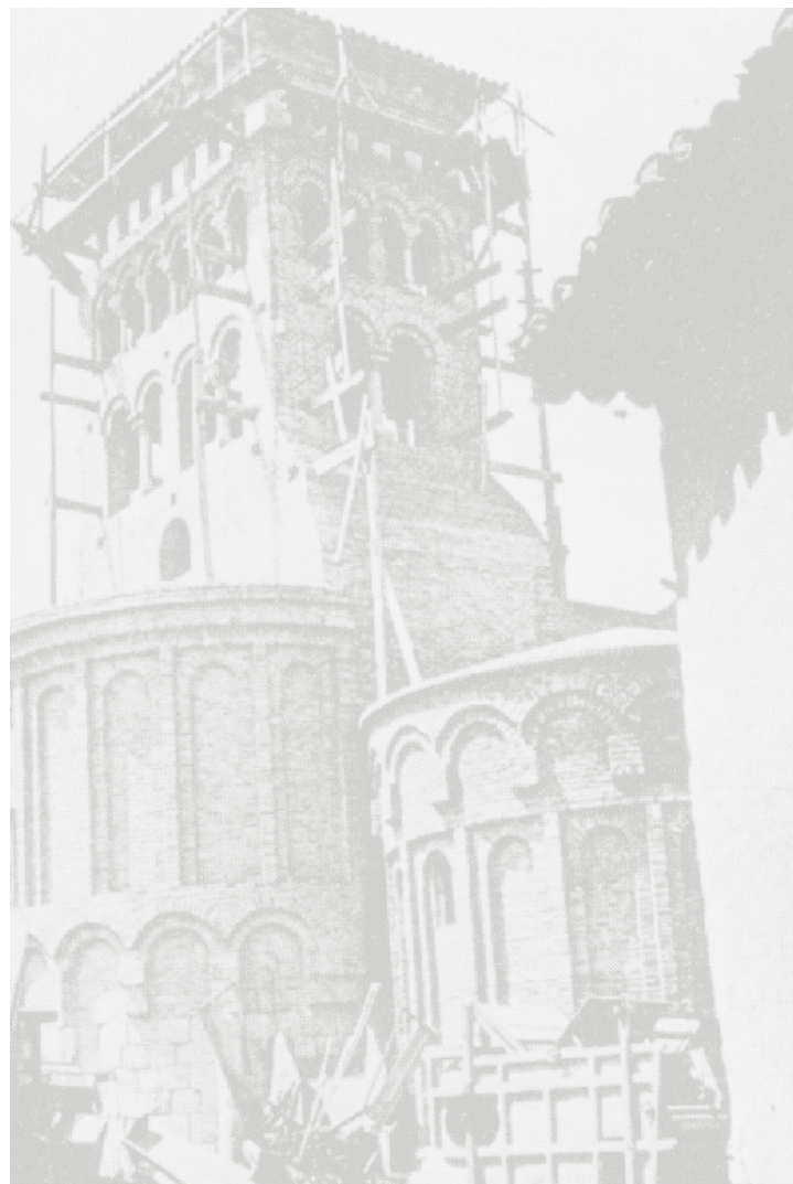
La torre campanario y el ábside de San Tirso en fase de reconstrucción. Foto Luis Menéndez-Pidal
