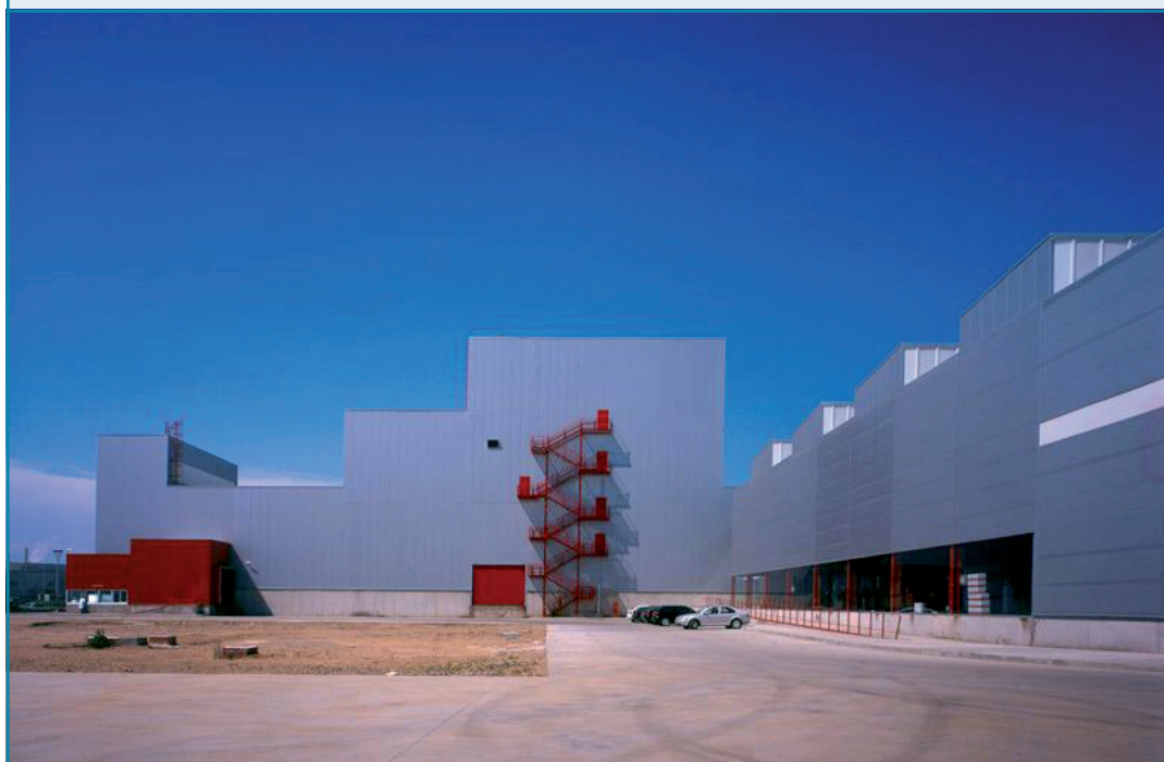
Imagen 2: Exterior. Detalle de los volúmenes y la escalera. En construcción. Fotografía: cortesía del estudio Espegel-Fisac.
