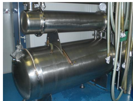
Figura 20. Contenedores del agua extraída
