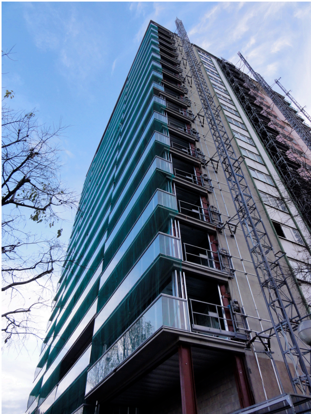
Figuras II-3 y 4: Imágenes de la obra de reciclaje urbano de la torre Bois Le Prêtre (París), tomadas en noviembre 2010 durante una visita guiada por el arquitecto Frédéric Druot. Fotografías de la autora.
