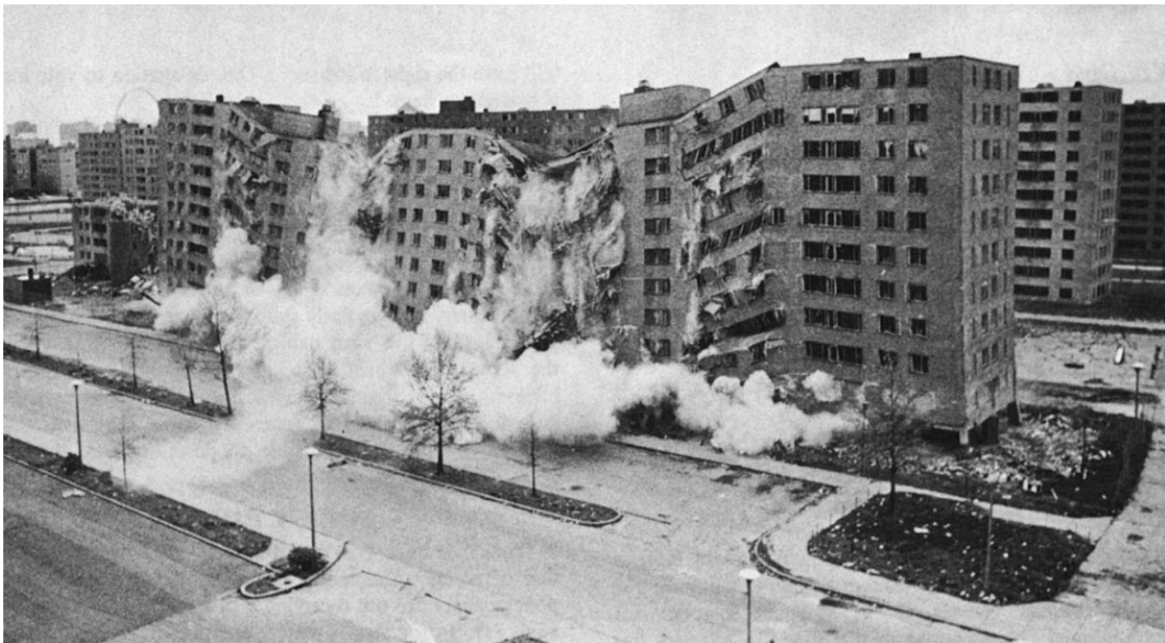
Figura II-20.: Escena de la demolición de Pruitt-Igoe (Saint Louis, Missouri), el 16 de marzo de 1972. Fuente: Carlos García Vázquez.
