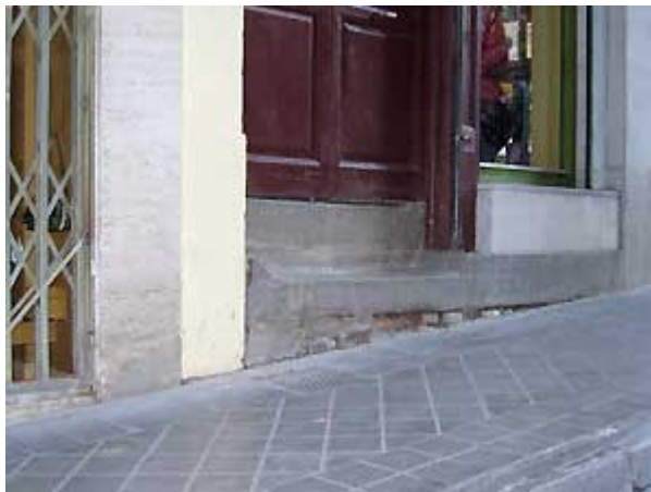
Ilustración 5. Reutilizada como escalón, en la calle Cucharras (2008).
