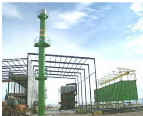
Figura I.5. Planta de Gasificación de Residuos Vegetales de Invernadero de Nijar.
