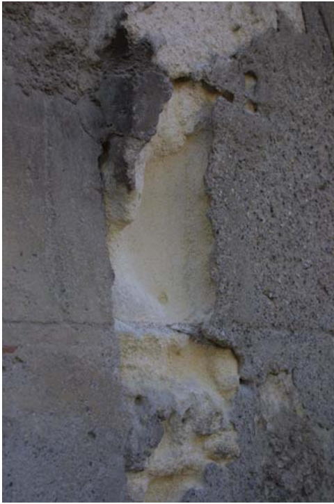
Figura 2.15. Calcarenita muy deteriorada bajo mortero moderno de cemento Pórtland, en la que son patentes fenómenos de disgregación (Fachada Norte del Hospital Real).
