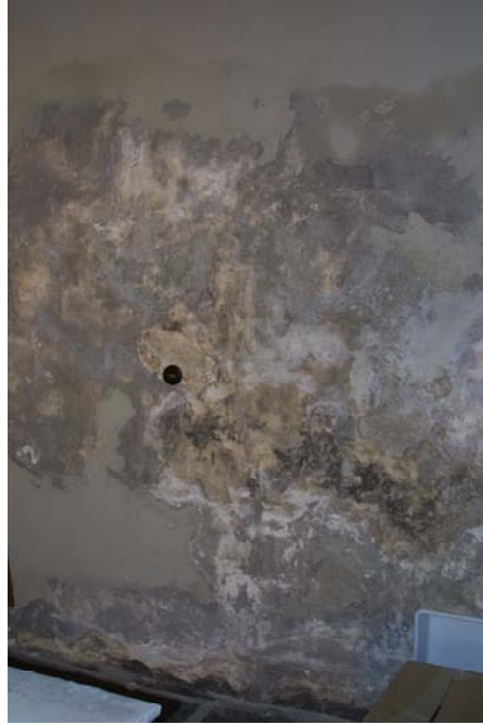
Figura 3.6. Revoco de cemento Pórtland aplicado en 2003 en la estancia situada a la izquierda del altar mayor de la Iglesia del Monasterio de San Jerónimo. Nótese los problemas de humedades y sales que han hecho que parte del revoco se desprenda.
