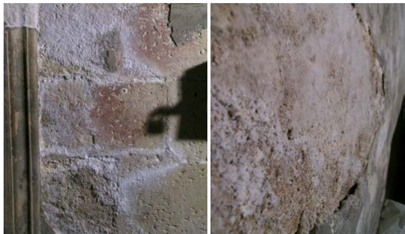
Figura 3.5. Eflorescencias y pérdidas de material en la estancia situada a la derecha del altar mayor, en el interior de la Iglesia del Monasterio de San Jerónimo.
