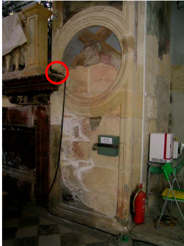
Figura 2.8. Zona piloto seleccionada en el Monasterio de San Jerónimo (derecha del altar mayor) para el estudio de las eflorescencias y daños. La localización del sensor de temperatura y humedad relativa se indica con un círculo.
