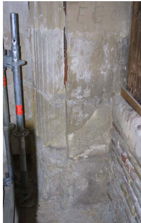
Figura 2.13. Fenómenos de desplazado debidos a la cristalización de sales en la Catedral de Granada. (Fecha del muestreo: Diciembre 2004)
