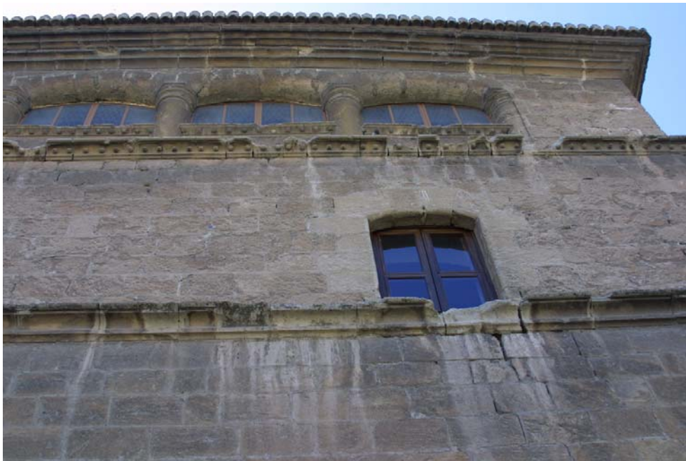
Figura 2.16. Pérdida de material en cornisas bajo las ventanas en el segundo cuerpo (Fachada Norte).
