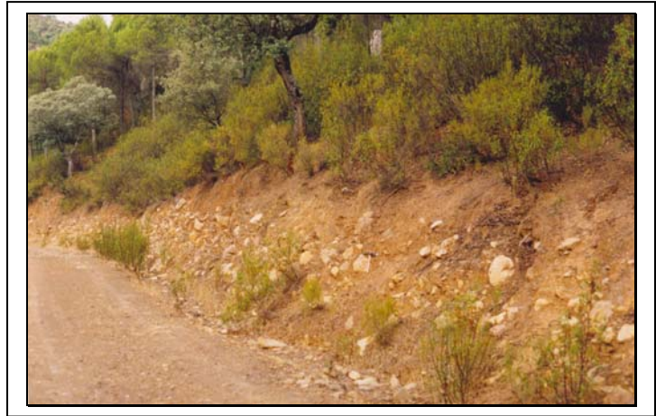
Fig. 227: Presencia de coluviones en al borde de carretera casa de la Huerta del Valle, en la zona al norte de la cuenca, en al margen derecho del arroyo de los Camerenes, zona del Puntal
