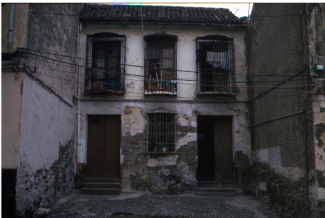
Ilustración 01. Inmueble n. 39 de calle Postigos de Málaga, estado de conservación en 1999. Fotografía del autor.
