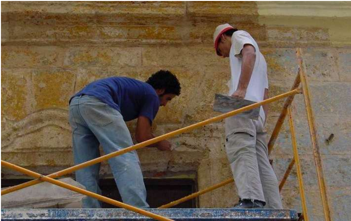
Trabajos de cantería en el pórtico de Teniente Rey 15. La fachada se descarnó y se dejó en la piedra original, consolidándola y dándole la apariencia actual de la casa.
