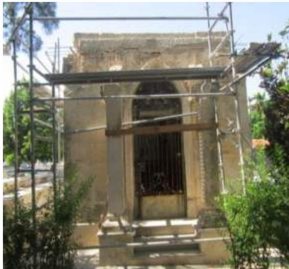
Fig. 157 Foto de antes de comenzar donde se notan todos los faltantes de los elementos desprendidos en la fachada de la capilla.
