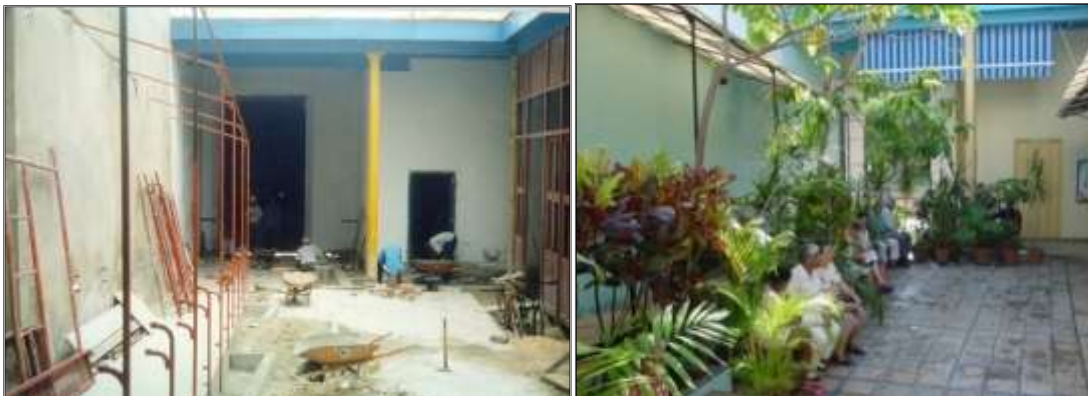
Interior en planta baja mirando hacia la calle Oficinas durante y después del proceso restaurador.
