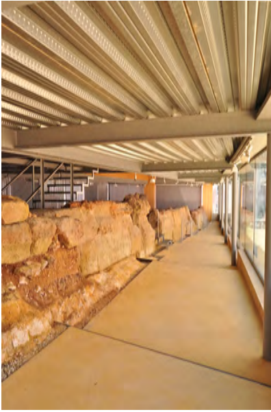
Fig. 356. Filtraciones subterráneas que deterioran la muralla provocando la creación de concreciones salinas. (Foto: Julia García, 2013)
