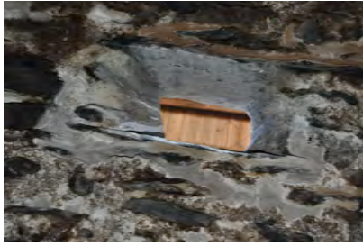
Fig. 435: Intedgración de lucerna correspondiente a la bóveda de la sala de agua fría. (Foto: Julia García, 2010)
