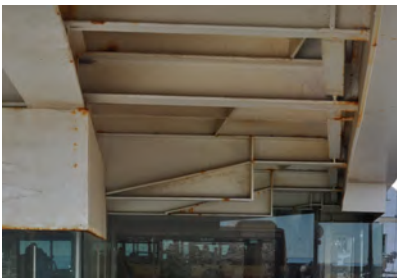
Fig. 450: Oxidación de la estructura moderna. (Foto: Julia García, 2015)
