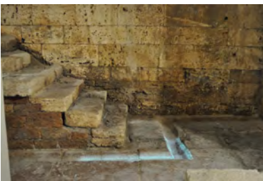
Fig. 521: Sistema de puesta en valor de canalización del agua en el Foro romano de Assisi. (Foto: Julia García, 2015)
