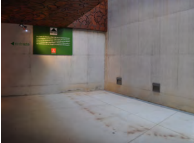
Fig. 185: Presencia de humedad en el pavimento por las filtraciones de agua de lluvia en la primera planta al no estar cubierta. (Foto: Julia García, 2015)
