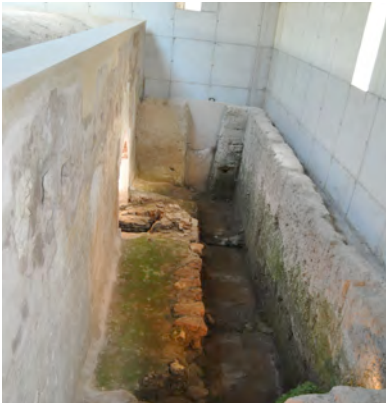
Fig. 412: Vista del estado de deterioro de la estancia afín a la caldera. (Foto: Julia García, 2012)
