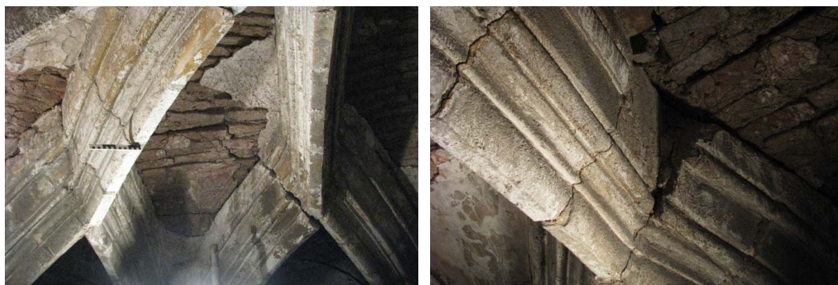
Figura 5. Grietas y desplazamientos en los nervios.
