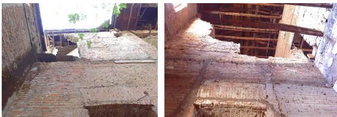
Figura 5: Grietas verticales y colapso del muro. Derecha: colapso de muro de 11.5 m de altura
