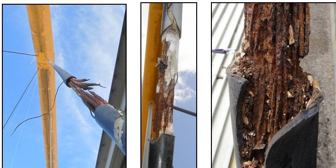
Figura 2. Fotografías en las que se puede observar el grado de deterioro de la péndola
